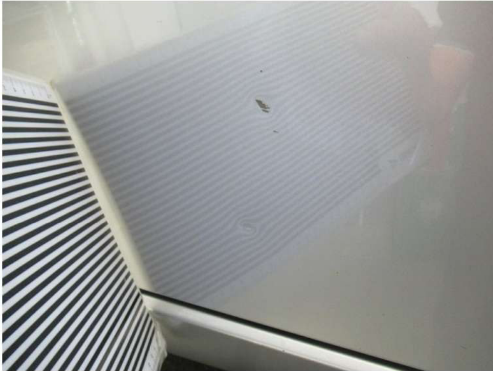
Bild 11 : - Tür hr eingedrückt
