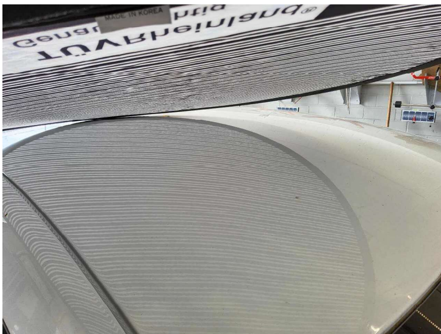
Bild 26 Dach Dachhaut Dellen
