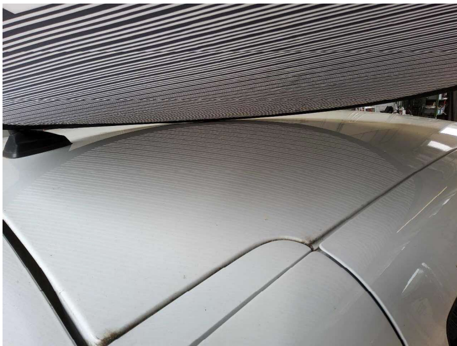
Bild 25 Dach Dachhaut Dellen
