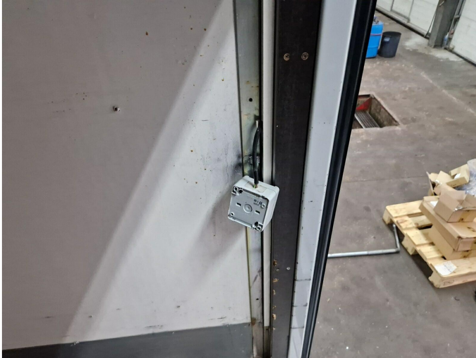
Bild 21 : Verkabelung im Laderaum/ Kofferaufbau teilweise gelöst
