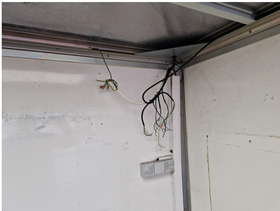
Bild 20 : Verkabelung im Laderaum/ Kofferaufbau teilweise gelöst
