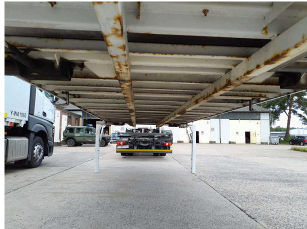
Gebrauchsspur 1: Karosserie: Karosserie - Korrosion - kein Abzug
