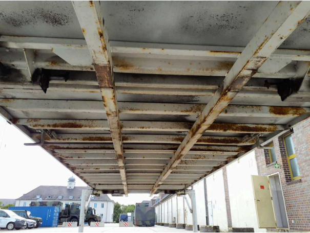
Gebrauchsspur 1: Sonstiges: Fahrzeug - Korrosion - kein Abzug
