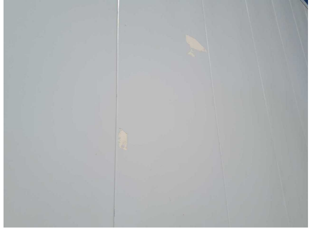
Beschädigung 1: Seitenwand links: Seitenwand - verkratzt / verschürft - instandsetzen und lackieren
