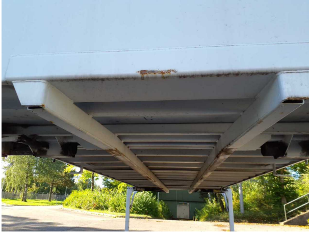
Gebrauchsspur 1: Karosserie: Karosserie - beschädigt - kein Abzug
