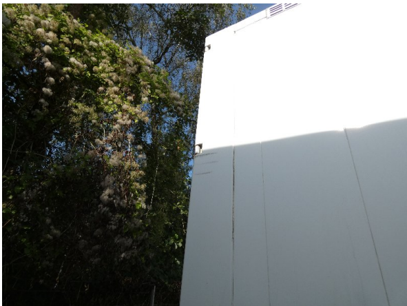
Bild 17: Portalrahmen rechts Kratzer - ohne Reparatur
