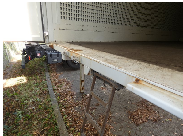
Bild 6: Portalrahmen unten Korrosion - teillackieren
