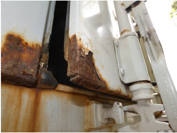
Bild 15: Hecktür rechts Korrosion - teillackieren
