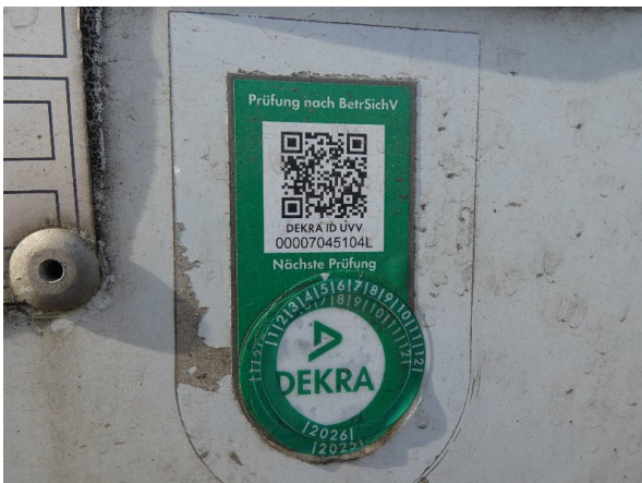
Bild 5: UVV Bescheinigung fehlt - erneuern
