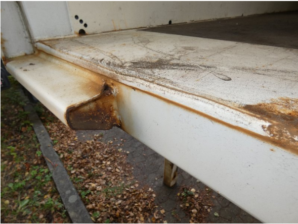
Bild 10: Portalrahmen unten Korrosion - teillackieren
