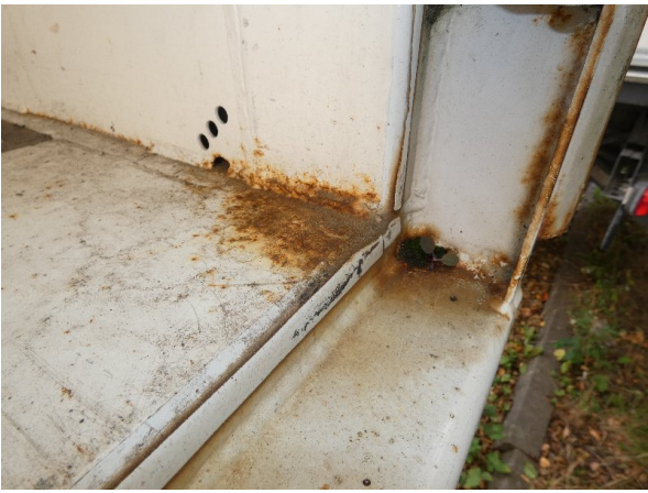
Bild 8: Portalrahmen unten Korrosion - teillackieren
