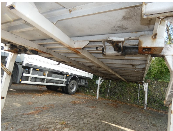
Bild 21: Rahmen und Stützbeine Korrosion - ohne Reparatur
