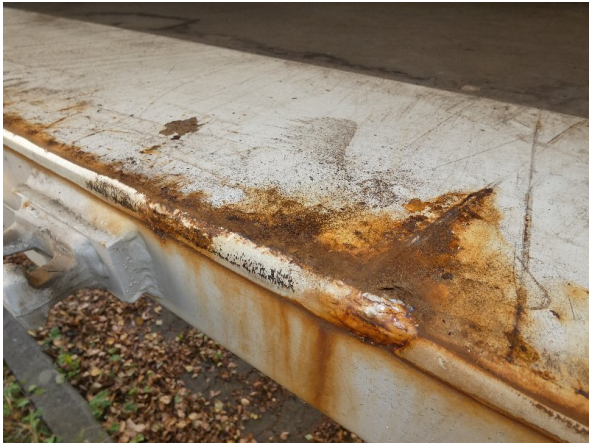
Bild 9: Portalrahmen unten Korrosion - teillackieren
