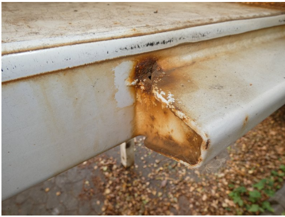
Bild 7: Portalrahmen unten Korrosion - teillackieren
