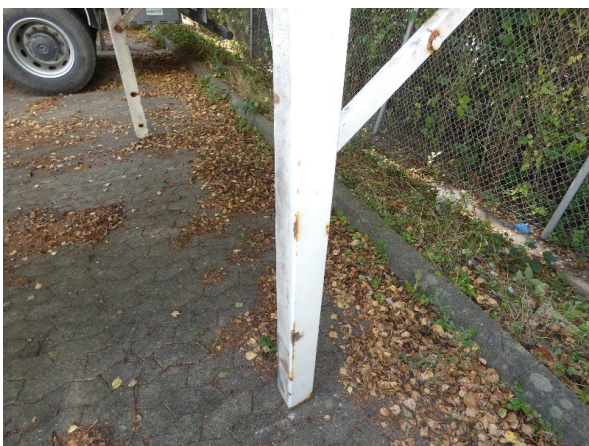
Bild 23: Rahmen und Stützbeine Korrosion - ohne Reparatur
