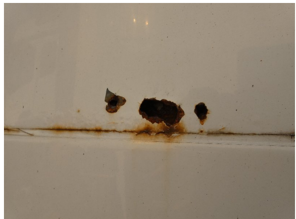
Bild 24: Seitenwand vorne links durchrostet - instandsetzen und lackieren
