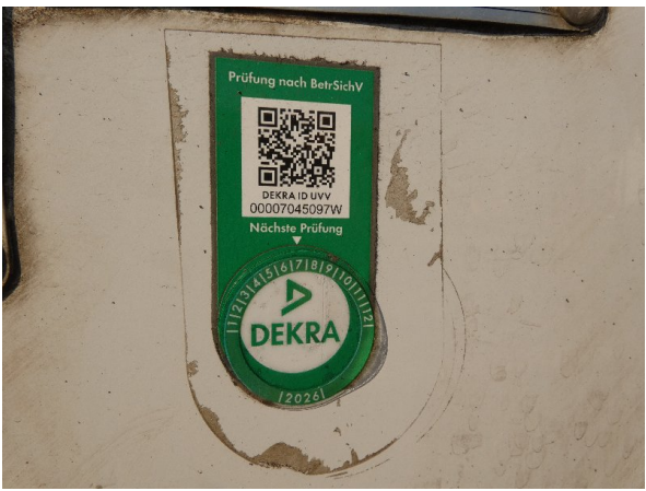
Bild 8: UVV Bescheinigung fehlt - erneuern
