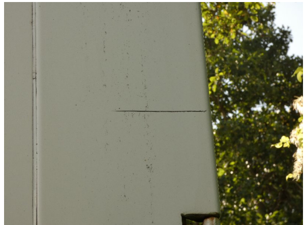
Bild 22: Portalrahmen links verkratzt - teillackieren
