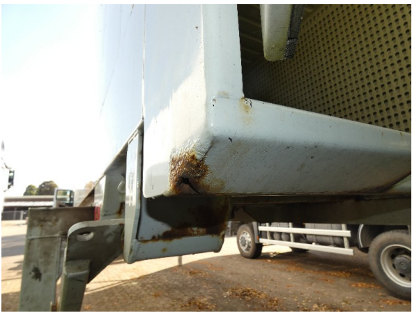
Bild 10: Portalrahmen unten Korrosion - lackieren
