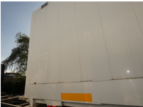
Bild 23: Seitenwand vorne links durchrostet - instandsetzen und lackieren
