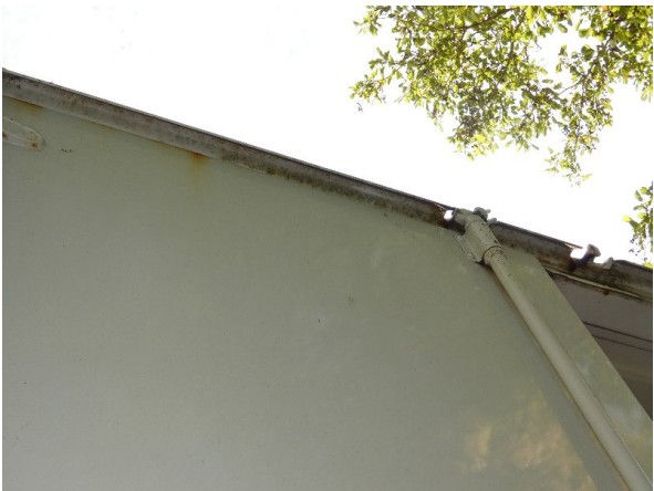
Bild 16: Hecktür links Korrosion - teillackieren
