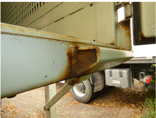
Bild 12: Portalrahmen unten Korrosion - lackieren
