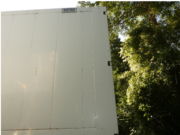
Bild 21: Portalrahmen links verkratzt - teillackieren
