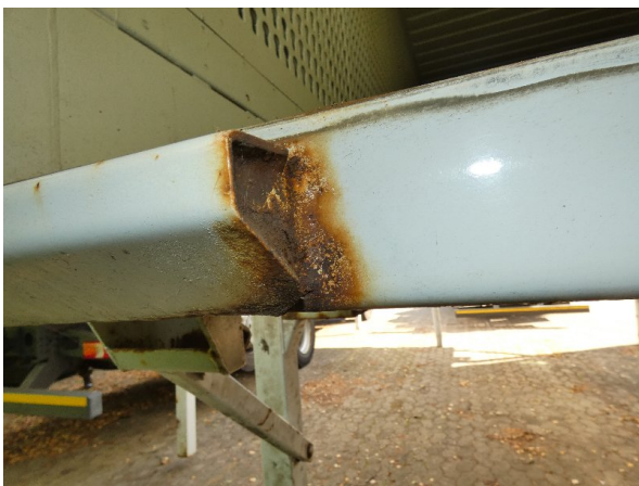
Bild 11: Portalrahmen unten Korrosion - lackieren
