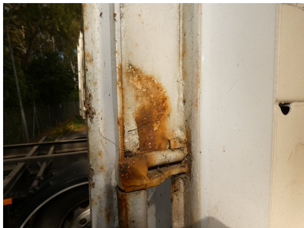
Bild 17: Portalrahmen links Korrosion - lackieren
