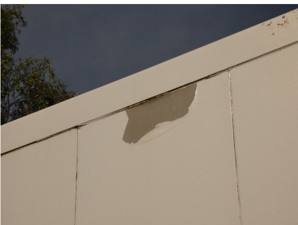
Bild 22: Seitenwand rechts Lackablösung - teillackieren
