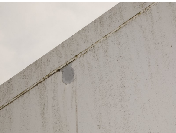
Bild 24: Seitenwand links Lackablösung, Korrosion - teillackieren
