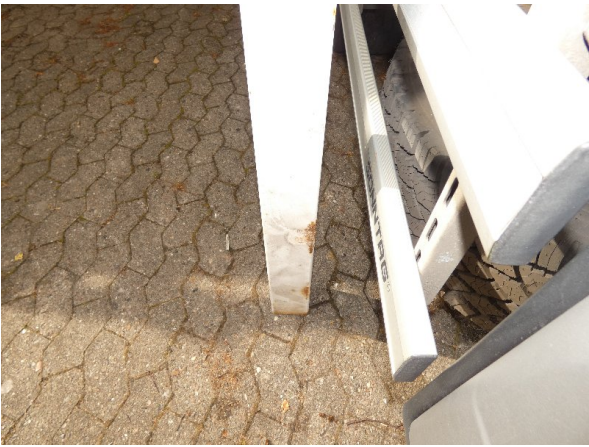
Bild 20: Rahmen und Stützbeine Korrosion - ohne Reparatur
