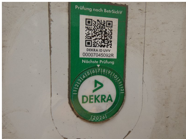
Bild 5: UUV Bescheinigung fehlt - erneuern
