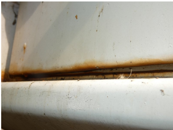
Bild 11: Hecktür links Korrosion - teillackieren
