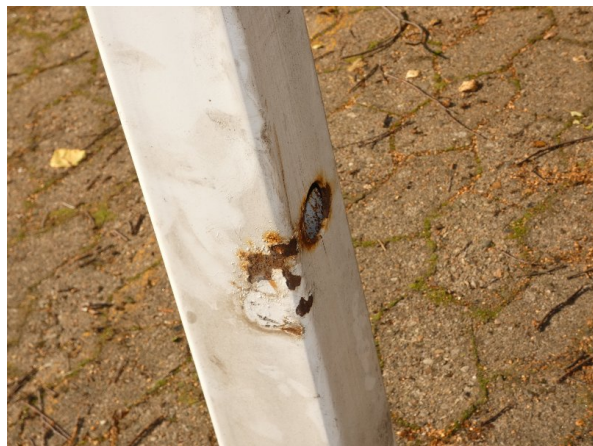
Bild 13: Rahmen und Stützbeine Korrosion - ohne Reparatur
