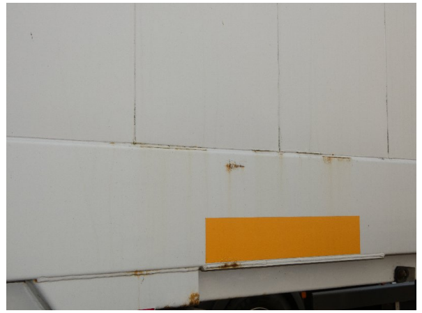
Bild 20: Unterzug rechts Korrosion - lackieren
