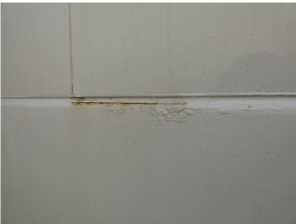
Bild 23: Unterzug rechts Korrosion - lackieren
