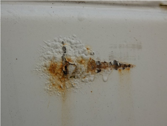
Bild 21: Unterzug rechts Korrosion - lackieren
