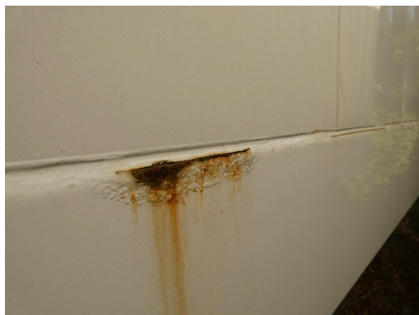
Bild 17: Unterzug links Korrosion - lackieren
