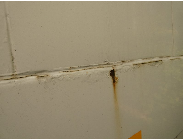
Bild 19: Unterzug links Korrosion - lackieren
