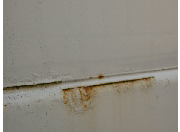
Bild 22: Unterzug rechts Korrosion - lackieren
