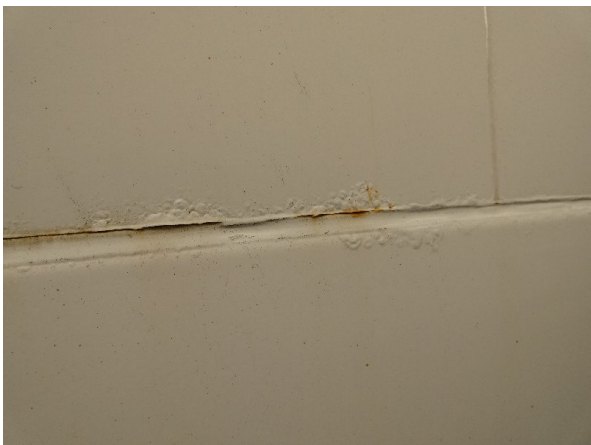
Bild 16: Unterzug links Korrosion - lackieren
