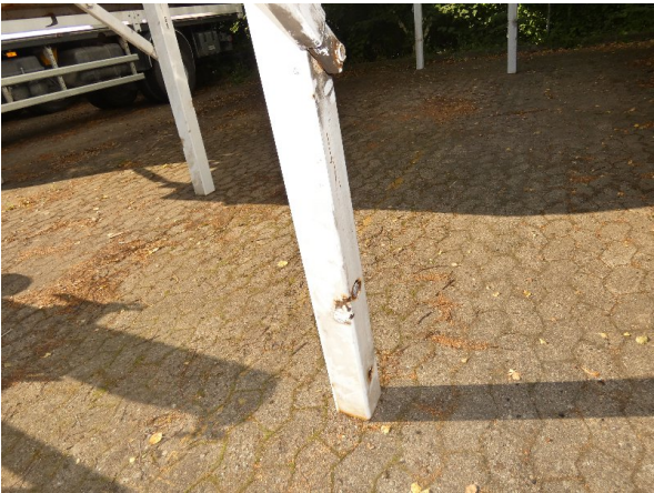
Bild 12: Rahmen und Stützbeine Korrosion - ohne Reparatur
