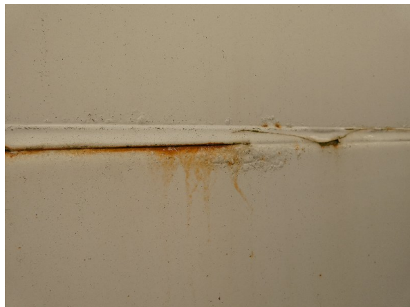
Bild 15: Unterzug links Korrosion - lackieren
