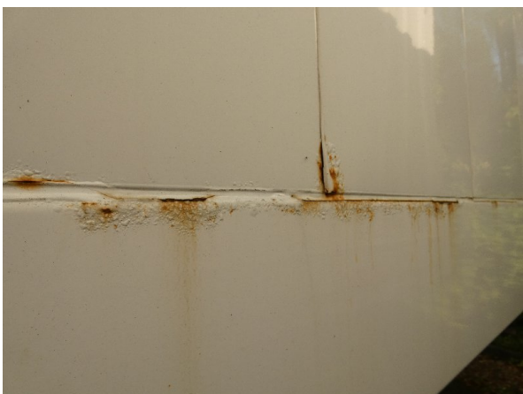
Bild 18: Unterzug links Korrosion - lackieren
