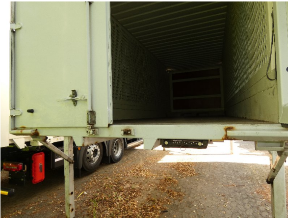
Bild 29: Portalrahmen unten Korrosion - lackieren
