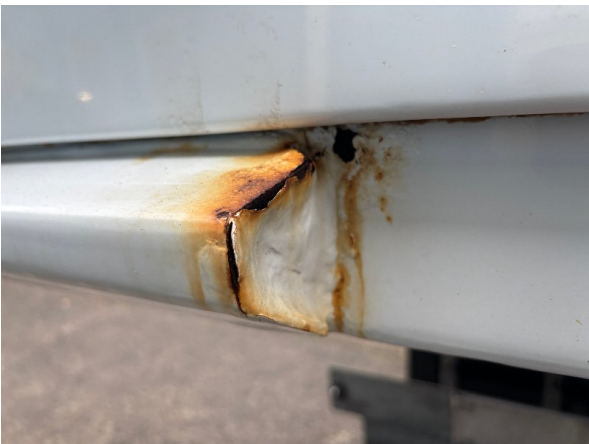
Bild 8: Container Korrosion - ohne Reparatur
