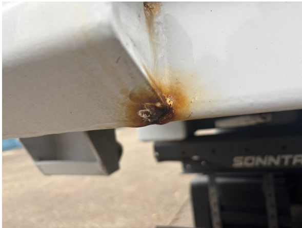
Bild 5: Container Korrosion - ohne Reparatur
