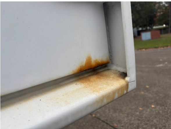
Bild 6: Container Korrosion - ohne Reparatur
