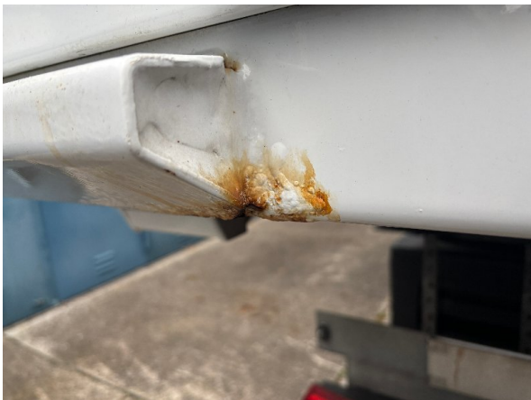
Bild 7: Container Korrosion - ohne Reparatur
