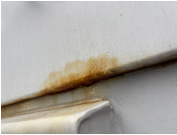
Bild 7: Container Korrosion - ohne Reparatur
