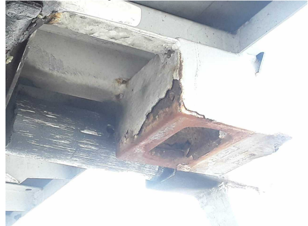
Gebrauchsspur 1: Sonstiges: Sonstiges (Rahmengruppe) - Korrosion - kein Abzug
