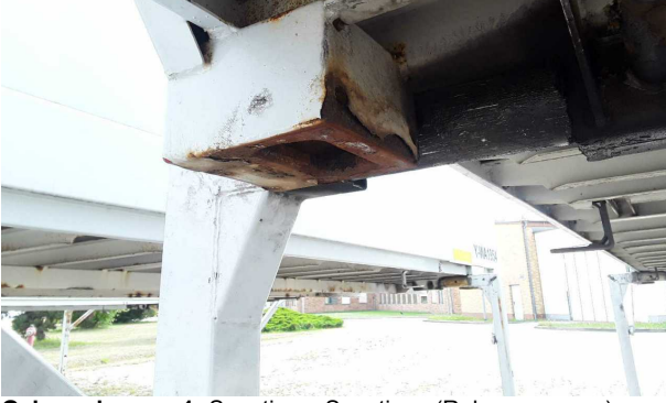
Gebrauchsspur 1: Sonstiges: Sonstiges (Rahmengruppe) - Korrosion - kein Abzug
