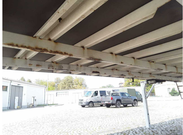
Gebrauchsspur 1: Sonstiges: Sonstiges (Rahmengruppe) - Korrosion - kein Abzug
