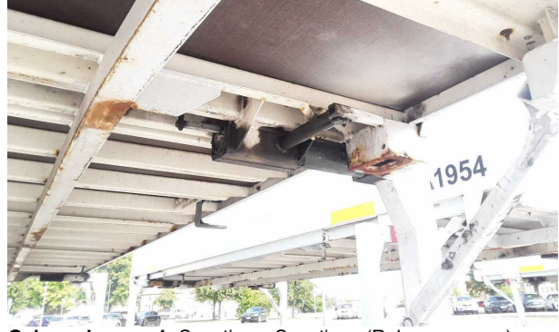
Gebrauchsspur 1: Sonstiges: Sonstiges (Rahmengruppe) - Korrosion - kein Abzug
