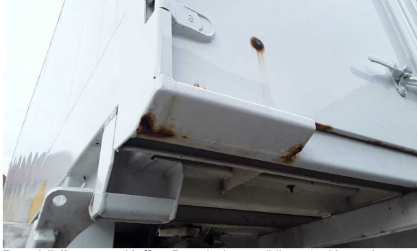
Beschädigung 4: Koffer: Portalrahmen (Hinten) - Korrosion - instandsetzen und lackieren
