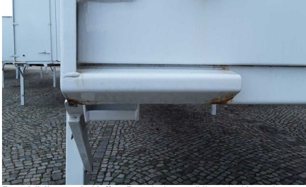
Beschädigung 3: Koffer: Portalrahmen (Hinten) - Korrosion - instandsetzen und lackieren
