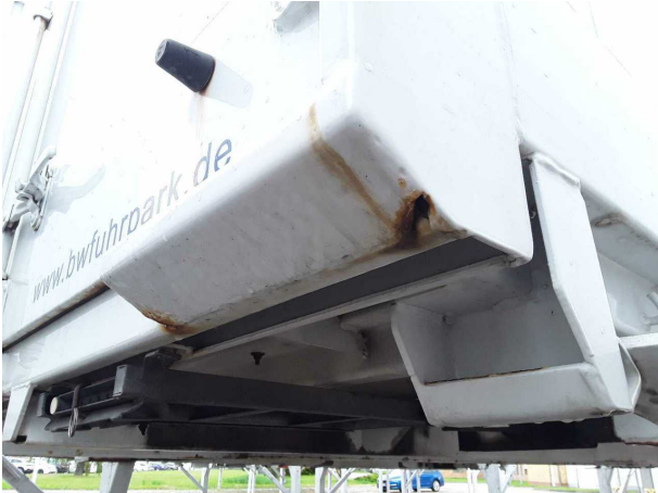
Beschädigung 4: Koffer: Portalrahmen (Hinten) - Korrosion - instandsetzen und lackieren
