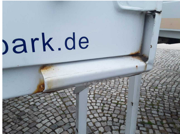
Beschädigung 3: Koffer: Portalrahmen (Hinten) - Korrosion - instandsetzen und lackieren
