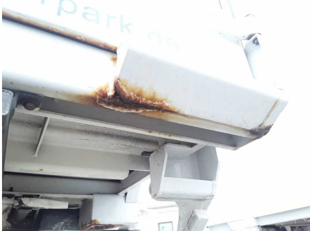
Gebrauchsspur 2: Koffer: Portalrahmen (Hinten) - Korrosion - k... Abzug
