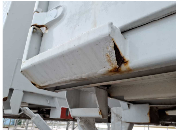
Beschädigung 2: Koffer: Portalrahmen - Korrosion - instandsetzen und lackieren
