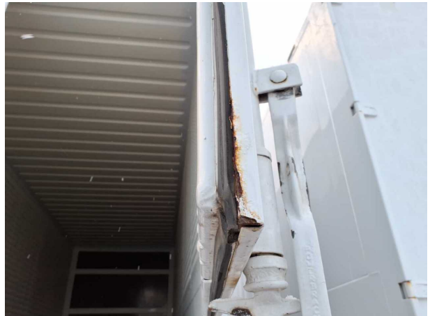
Beschädigung 4: Heckklappe/-tür: Hecktür rechts - Korrosio... instandsetzen und lackieren
