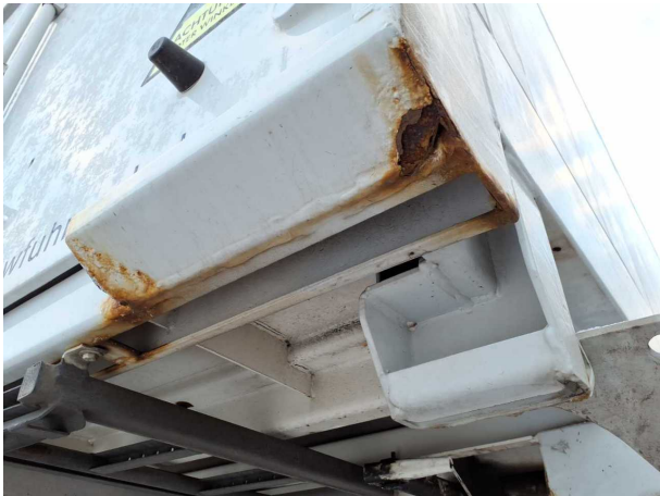
Beschädigung 2: Koffer: Portalrahmen - Korrosion - instandsetzen und lackieren
