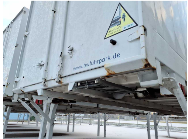
Beschädigung 2: Koffer: Portalrahmen - Korrosion - instandsetzen und lackieren
