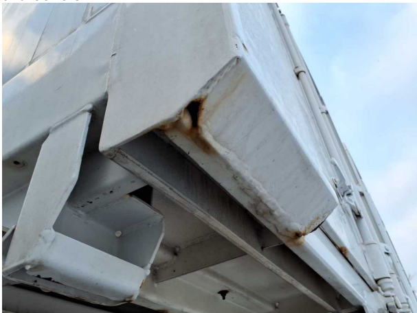
Beschädigung 2: Koffer: Portalrahmen - Korrosion - instandsetzen und lackieren
