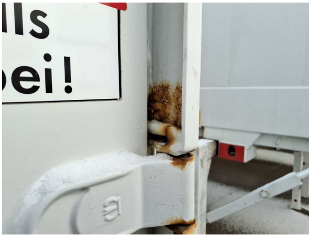
Beschädigung 3: Koffer: Portalrahmen - Korrosion - instandsetz... und lackieren
