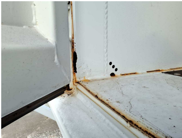
Beschädigung 3: Koffer: Portalrahmen - Korrosion - instandsetz... und lackieren
