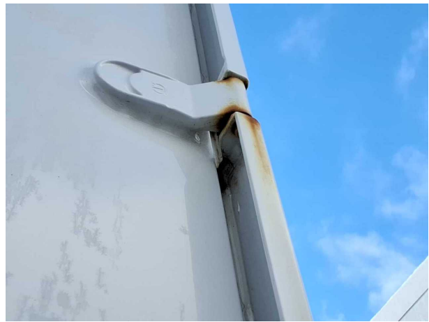
Beschädigung 3: Koffer: Portalrahmen - Korrosion - instandsetzen und lackieren
