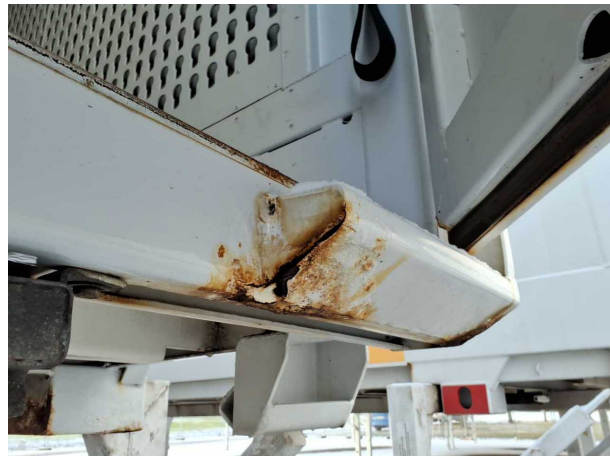
Beschädigung 3: Koffer: Portalrahmen - Korrosion - instandsetzen und lackieren
