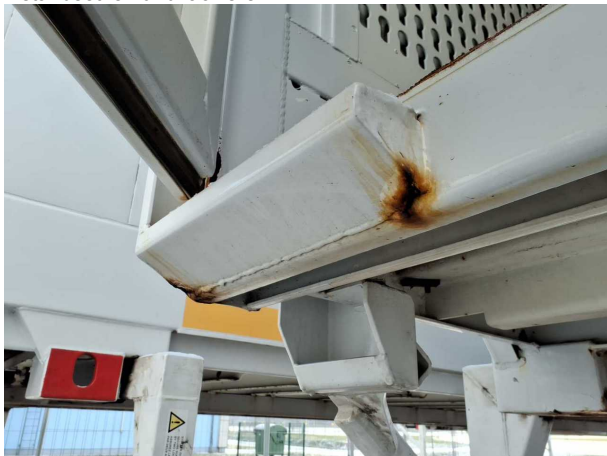
Beschädigung 3: Koffer: Portalrahmen - Korrosion - instandsetz... und lackieren
