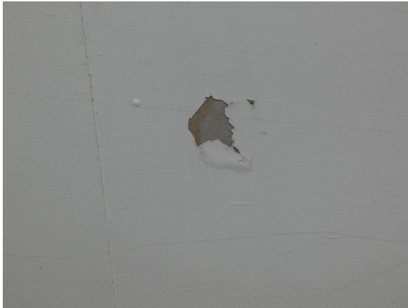
Bild 13: Seitenwand beschädigt - instandsetzen und lackieren
