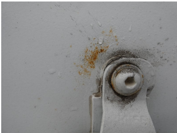
Bild 25: Tür Korrosion - instandsetzen und lackieren
