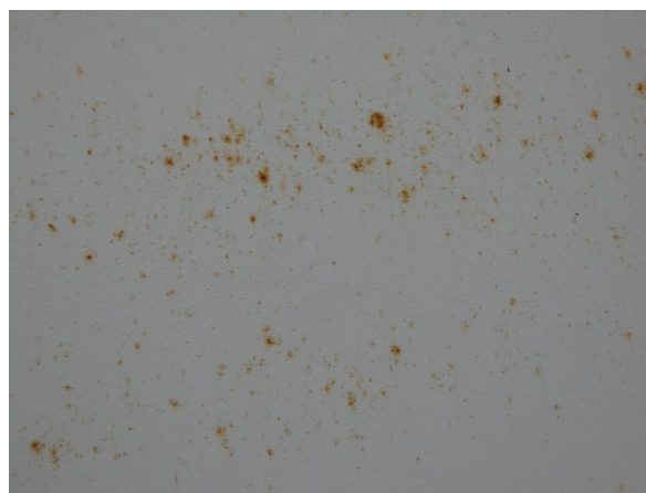
Bild 22: Tür Korrosion - instandsetzen und lackieren
