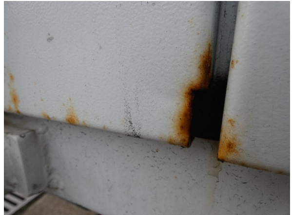
Bild 24: Tür Korrosion - instandsetzen und lackieren
