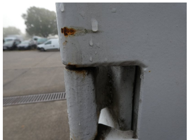
Bild 16: Seitenwand beschädigt - instandsetzen und lackieren
