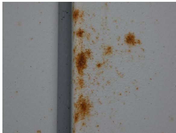
Bild 20: Tür Korrosion - instandsetzen und lackieren
