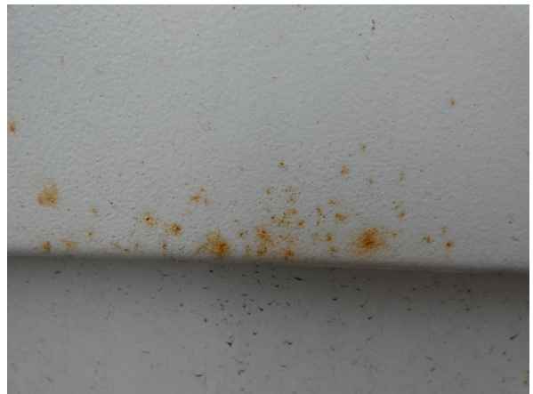
Bild 26: Tür Korrosion - instandsetzen und lackieren
