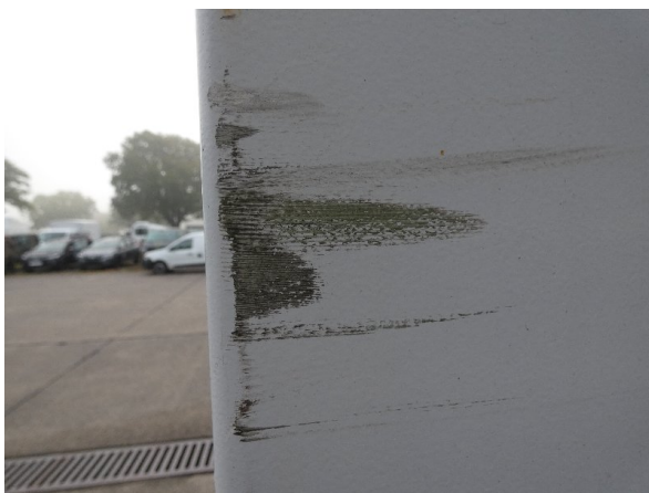
Bild 15: Seitenwand beschädigt - instandsetzen und lackieren
