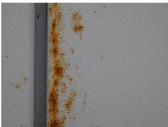
Bild 21: Tür Korrosion - instandsetzen und lackieren
