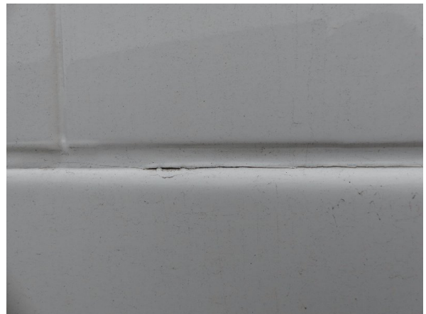
Bild 22: Abdichtung Seitenwand beschädigt - erneuern
