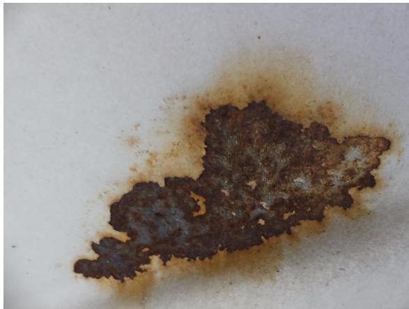
Bild 33: Unterboden Korrosion - instandsetzen und lackieren
