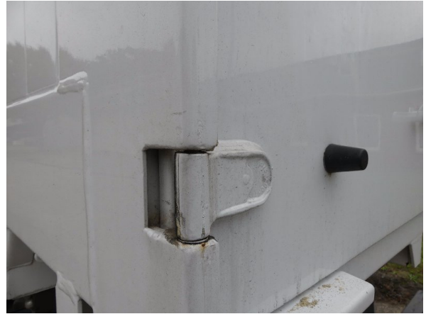
Bild 20: Eckbeplankung links Korrosion - instandsetzen und lackieren
