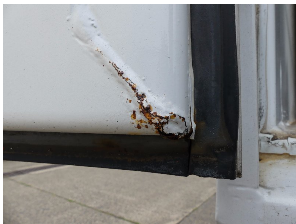
Bild 13: Tür Korrosion - instandsetzen und lackieren
