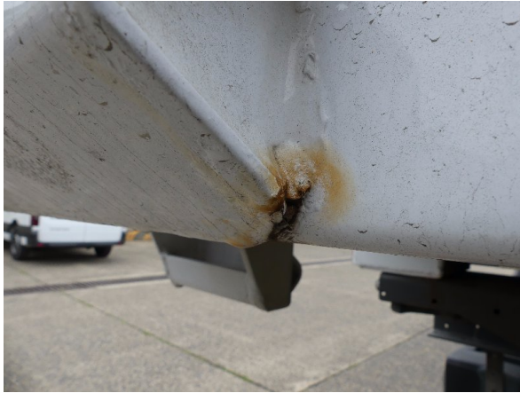
Bild 19: Eckbeplankung links Korrosion - instandsetzen und lackieren
