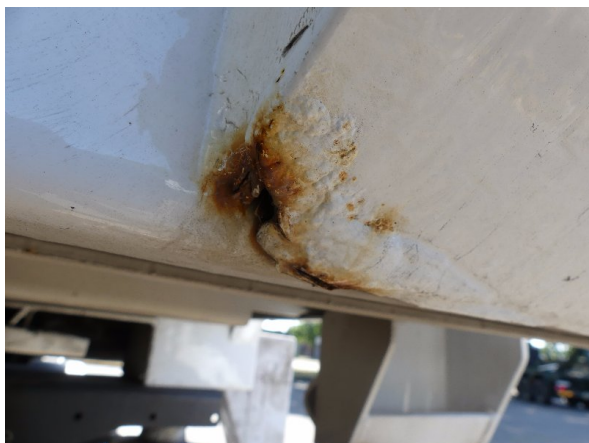
Bild 15: Eckbeplankung rechts Korrosion - instandsetzen und lackieren
