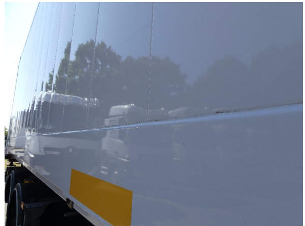
Bild 24: Abdichtung links und rechts beschädigt - erneuern
