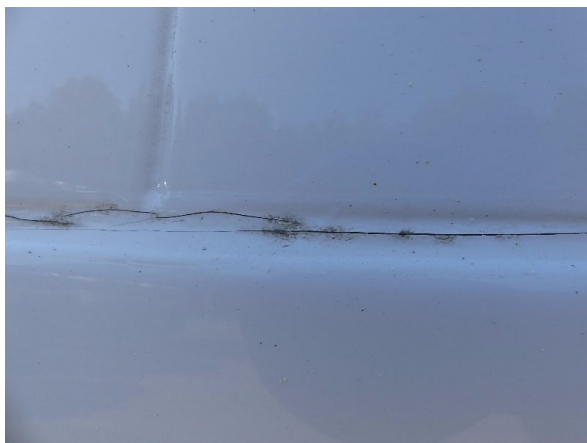
Bild 25: Abdichtung links und rechts beschädigt - erneuern
