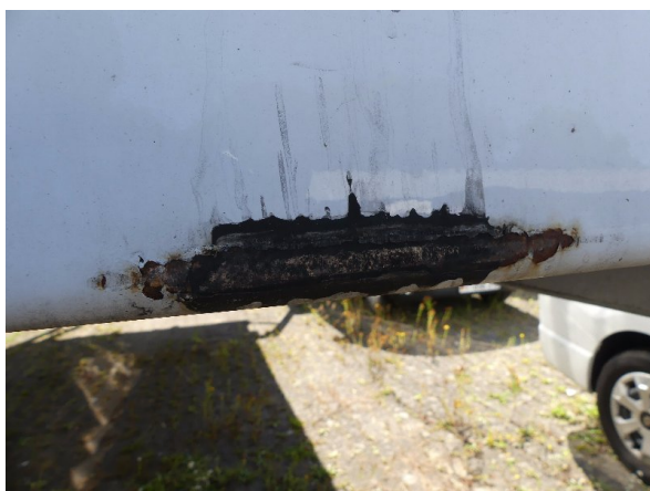
Bild 27: Frontwand Korrosion - instandsetzen und lackieren
