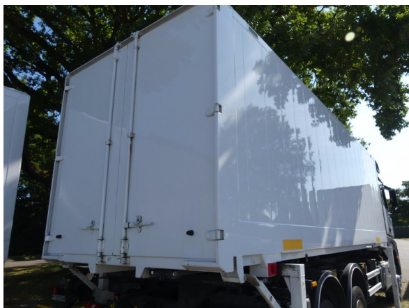
Bild 15: Eckbeplankung rechts Korrosion - instandsetzen und lackieren
