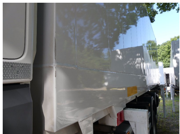
Bild 18: Abdichtung beschädigt - erneuern
