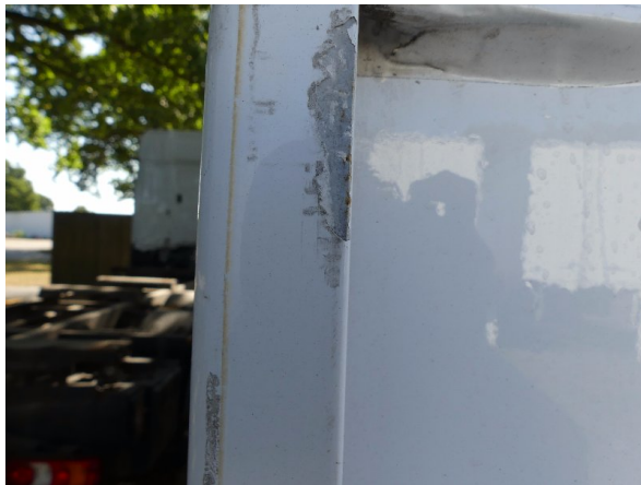
Bild 13: Eckbeplankung links Korrosion - instandsetzen und lackieren
