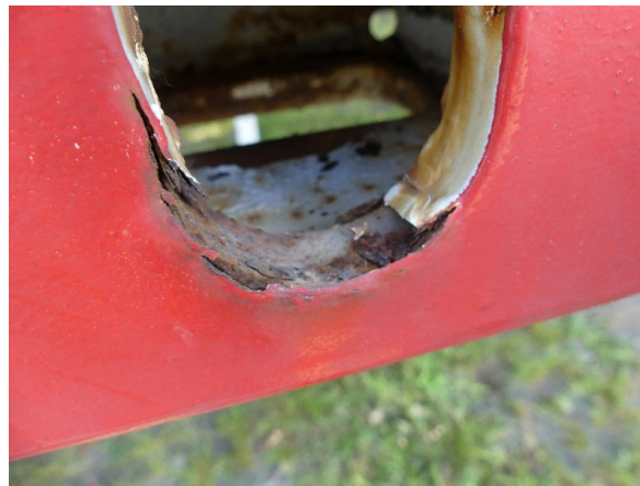
Bild 20: Aufnahmen Korrosion - instandsetzen und lackieren
