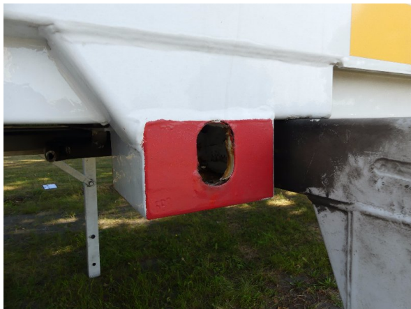
Bild 19: Aufnahmen Korrosion - instandsetzen und lackieren
