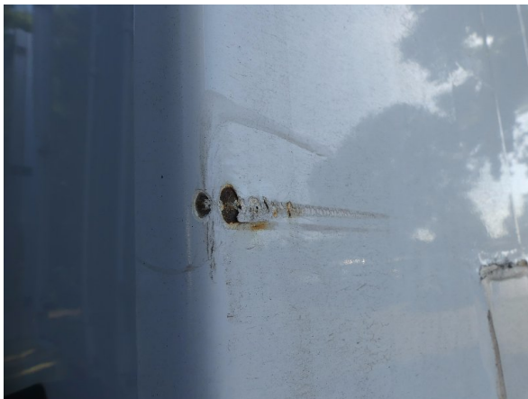
Bild 31: Eckbeplankung rechts Korrosion - instandsetzen und lackieren
