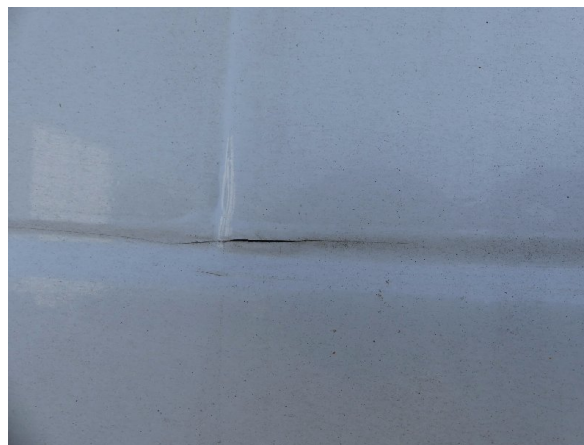
Bild 24: Abdichtungen rechts und links beschädigt - erneuern
