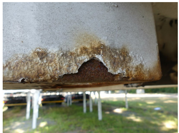
Bild 18: Aufnahmen Korrosion - instandsetzen und lackieren
