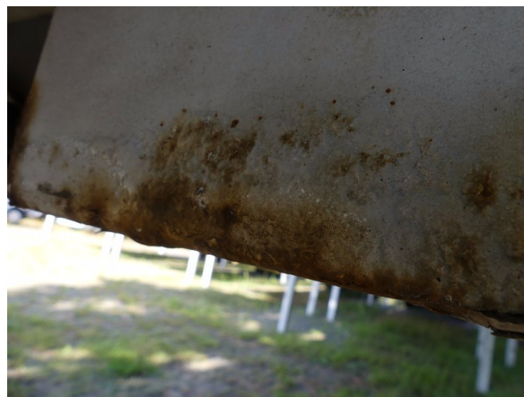
Bild 22: Aufnahmen Korrosion - instandsetzen und lackieren
