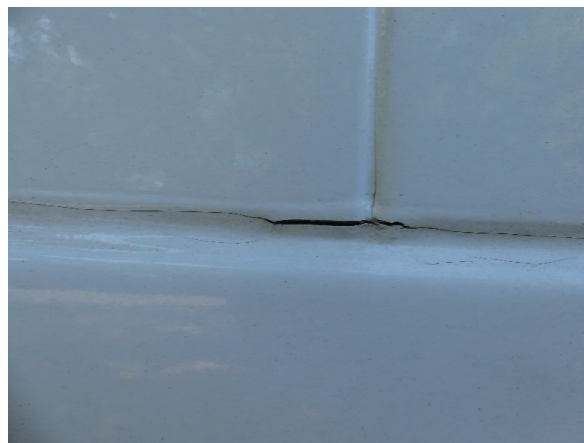
Bild 26: Abdichtungen rechts und links beschädigt - erneuern
