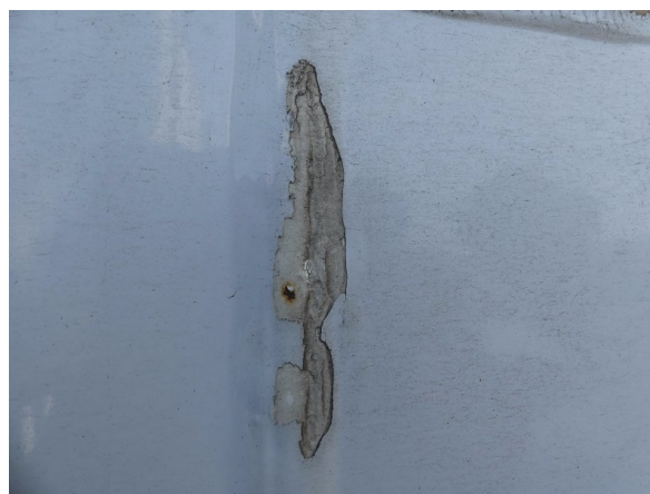
Bild 28: Seitenwand Lackmangel - lackieren
