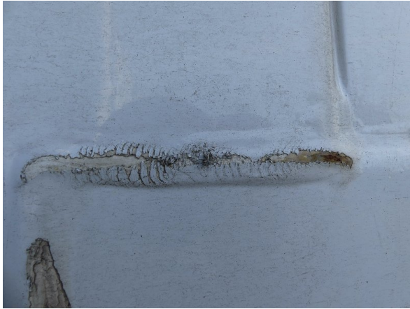
Bild 29: Seitenwand Lackmangel - lackieren
