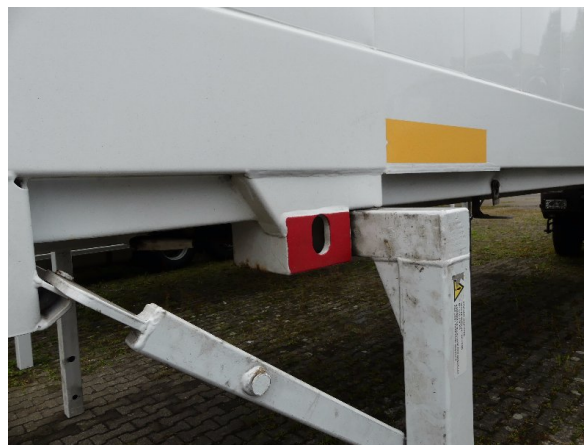
Bild 24: Aufnahmen Korrosion - instandsetzen und lackieren
