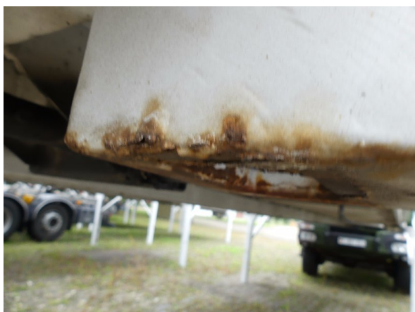
Bild 27: Aufnahmen Korrosion-instandsetzen und lackieren
