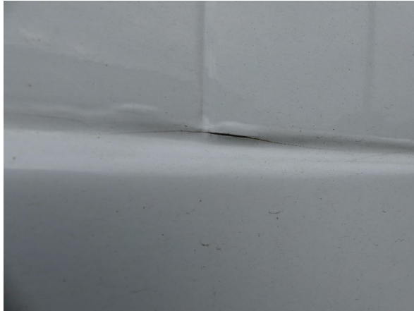
Bild 19: Abdichtung links und rechts beschädigt - erneuern
