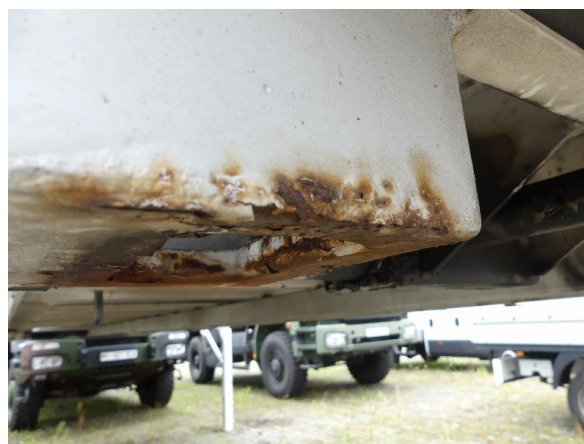
Bild 28: Aufnahmen Korrosion-instandsetzen und lackieren
