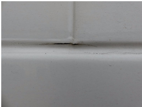
Bild 21: Abdichtung links und rechts beschädigt - erneuern
