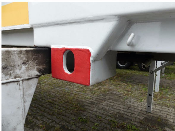
Bild 31: Aufnahmen Korrosion-instandsetzen und lackieren
