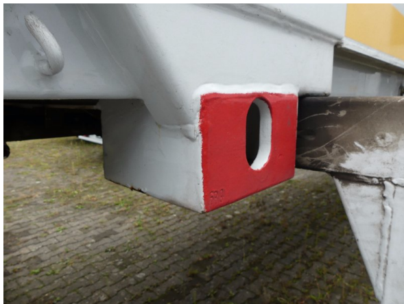
Bild 29: Aufnahmen Korrosion-instandsetzen und lackieren
