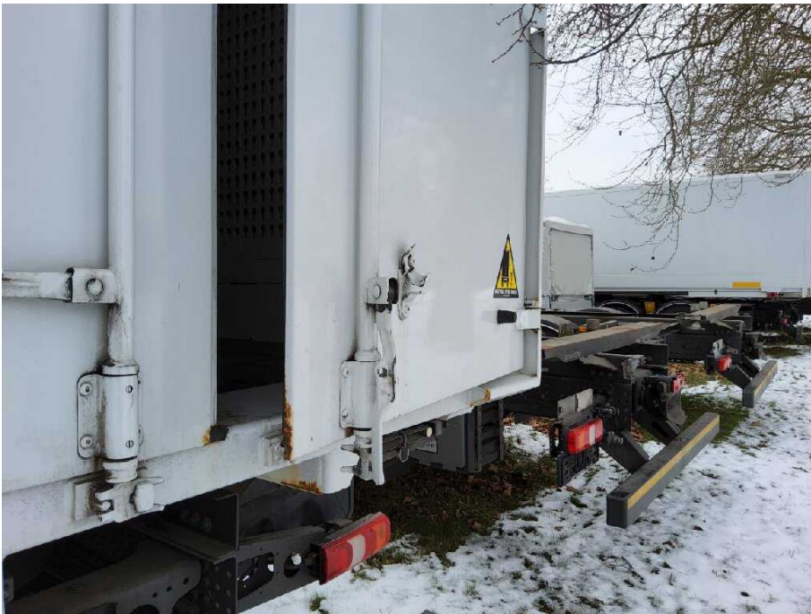
Bild 9 Fahrzeugheck Tür hinten rechts korrodiert
