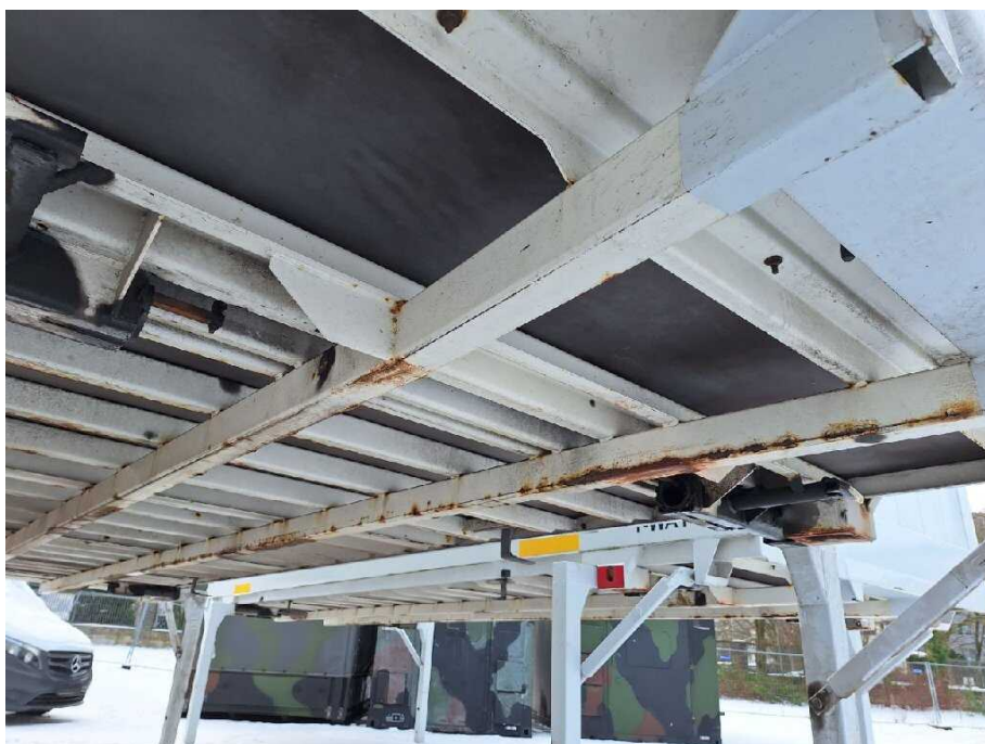
Bild 20 Aufbau Bodenrahmen hinten korrodiert
