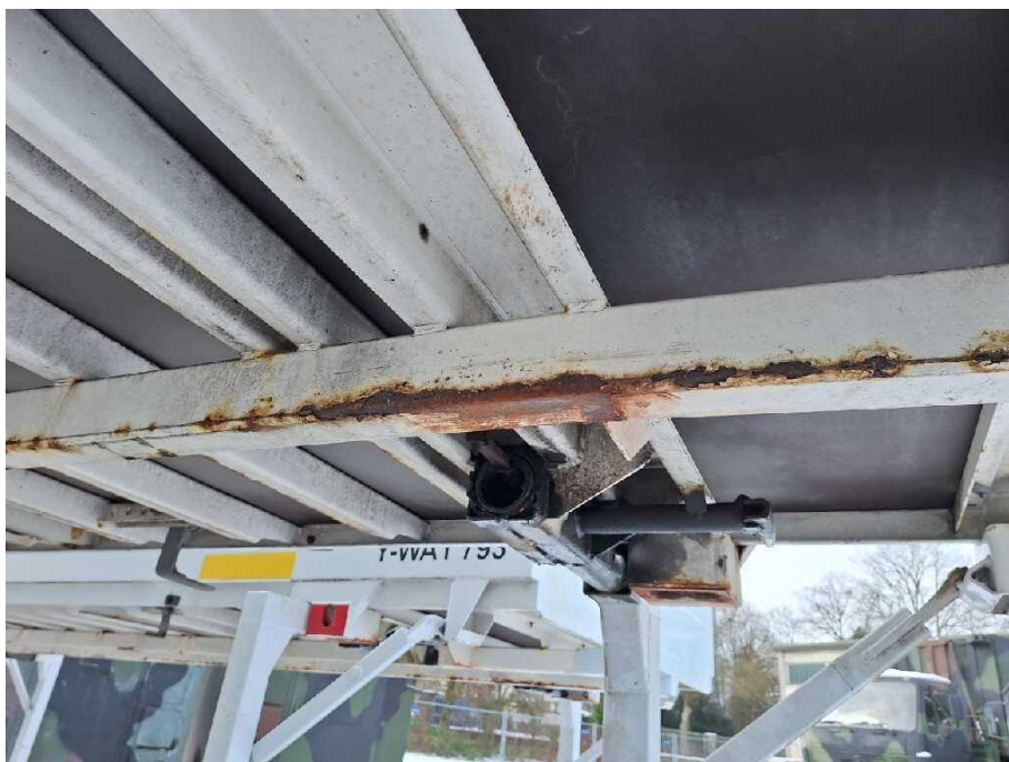
Bild 21 Aufbau Bodenrahmen hinten korrodiert
