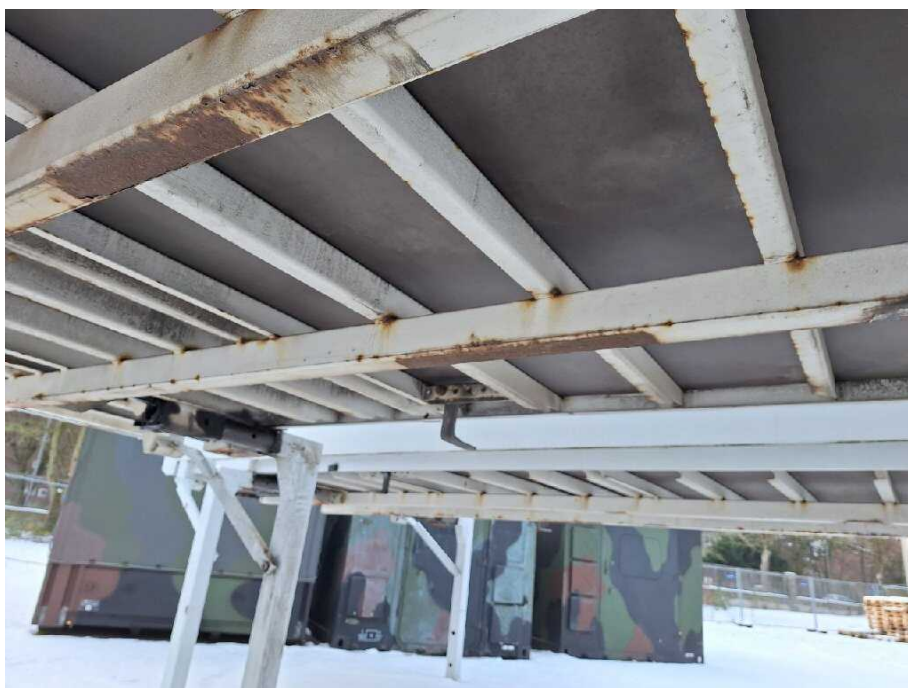
Bild 22 Aufbau Bodenrahmen hinten korrodiert
