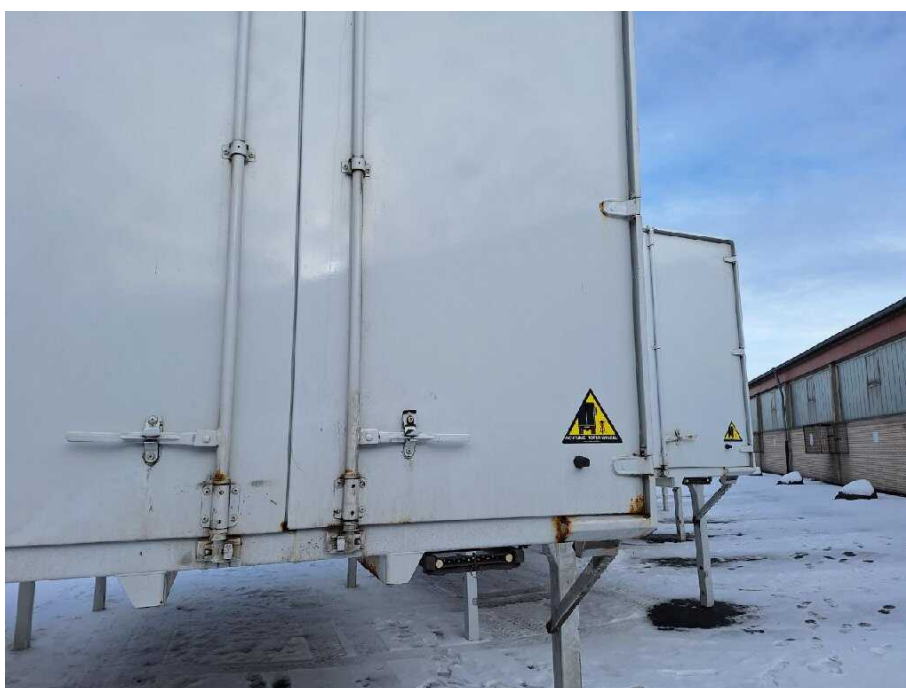
Bild 12 Fahrzeugheck Heckflügeltür rechts korrodiert
