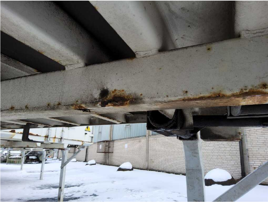
Bild 15 Aufbau Bodenrahmen hinten korrodiert
