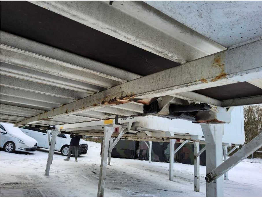
Bild 11 Aufbau Bodenrahmen hinten korrodiert
