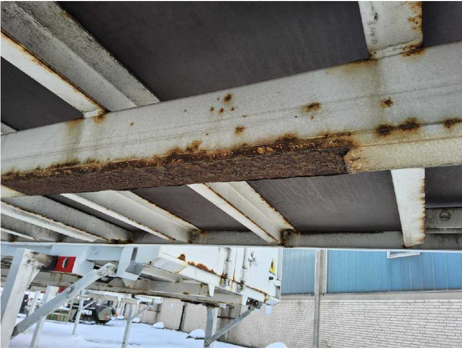
Bild 17 Aufbau Bodenrahmen hinten korrodiert
