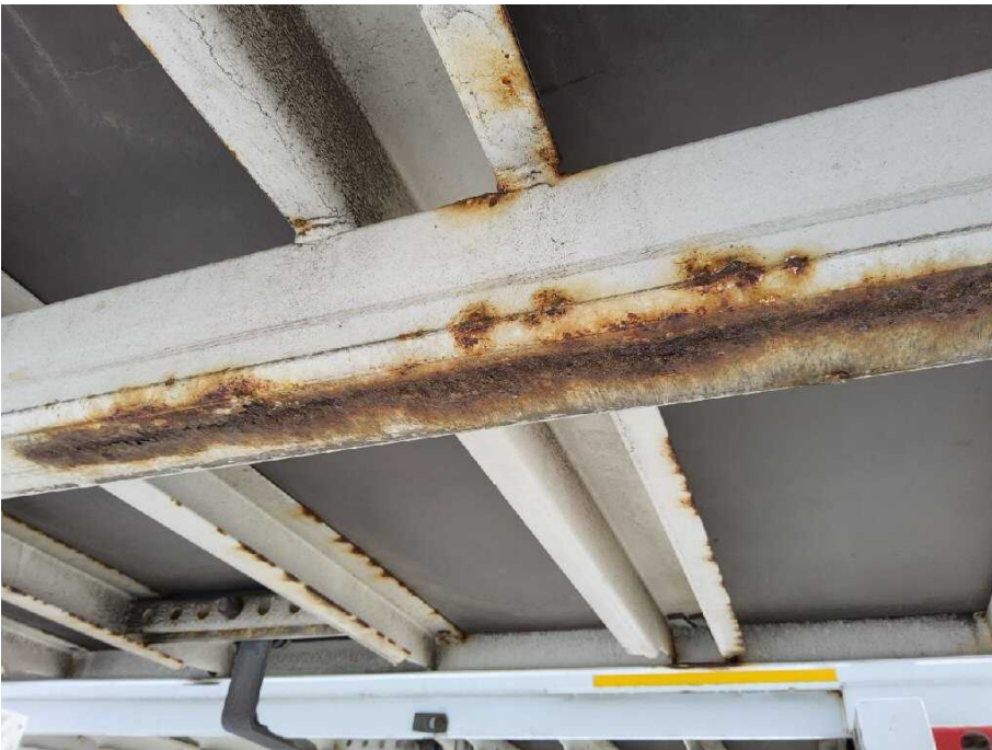
Bild 18 Aufbau Bodenrahmen hinten korrodiert
