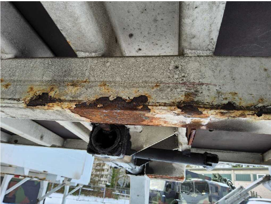
Bild 12 Aufbau Bodenrahmen hinten korrodiert
