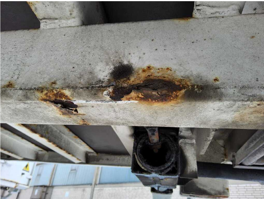
Bild 16 Aufbau Bodenrahmen hinten korrodiert
