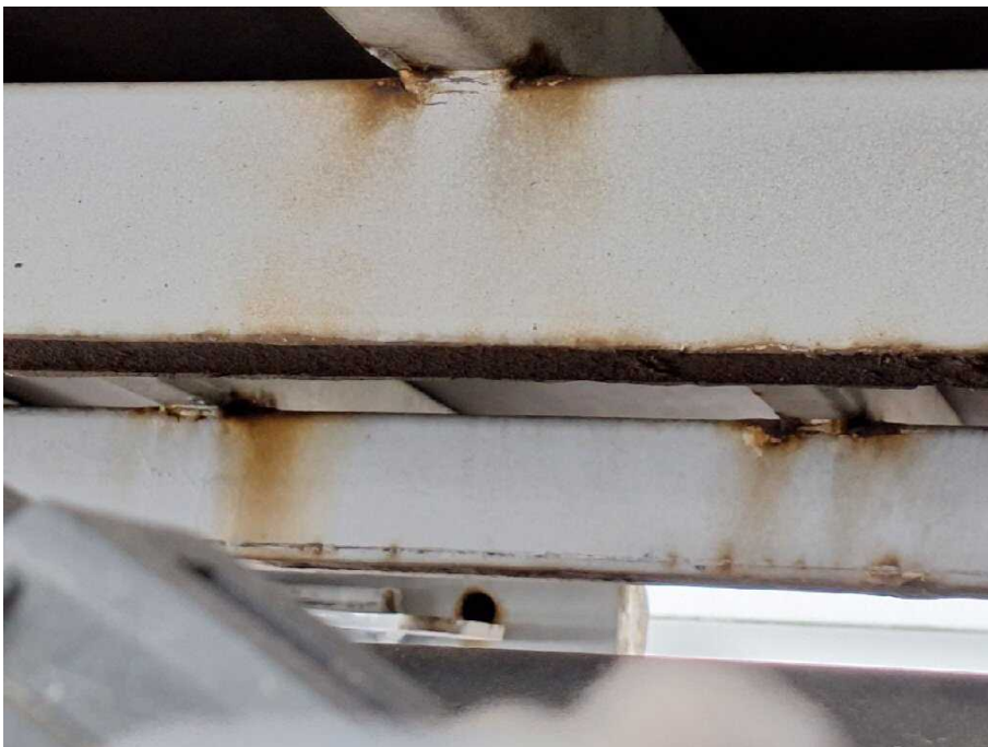
Bild 10 Aufbau Bodenrahmen hinten korrodiert
