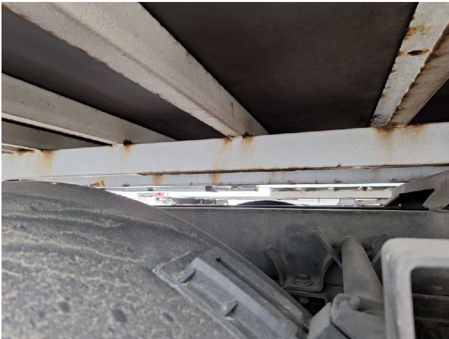
Bild 9 Aufbau Bodenrahmen hinten korrodiert
