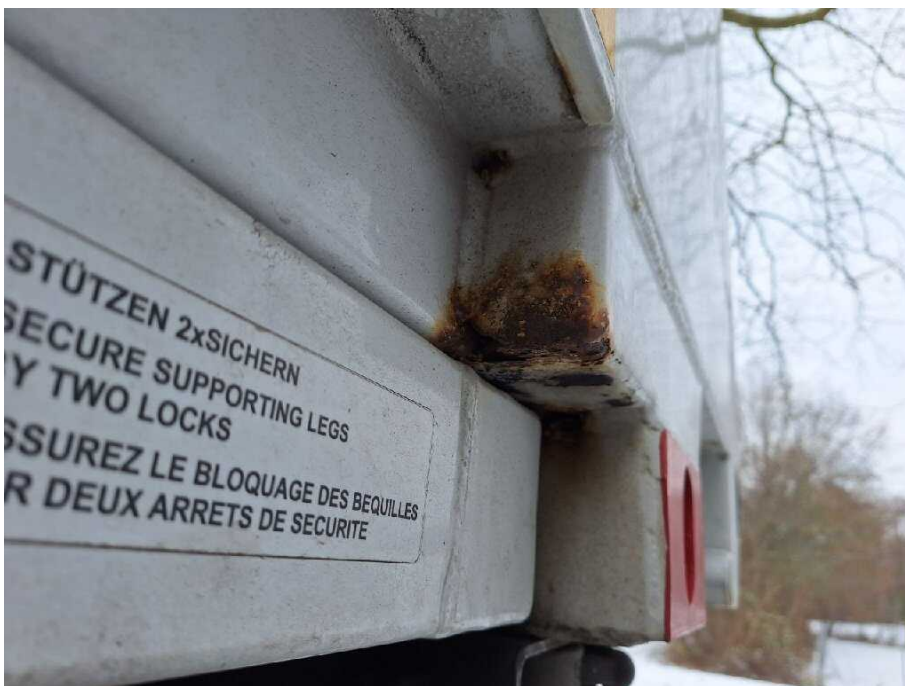
Bild 20 Fahrzeugfront Fahrzeugrahmen korrodiert
