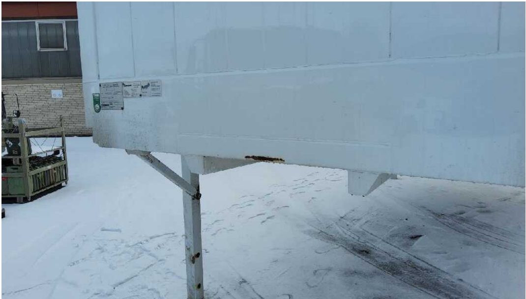
Bild 22 Fahrzeugfront Fahrzeugrahmen korrodiert
