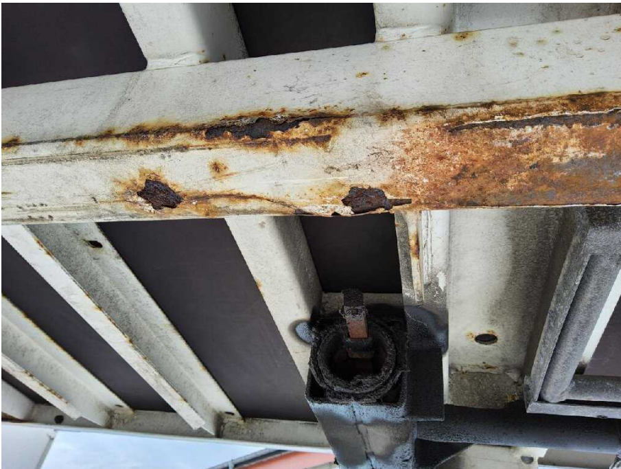
Bild 17 Aufbau Bodenrahmen hinten korrodiert
