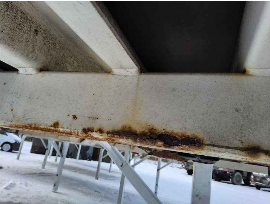
Bild 19 Aufbau Bodenrahmen hinten korrodiert
