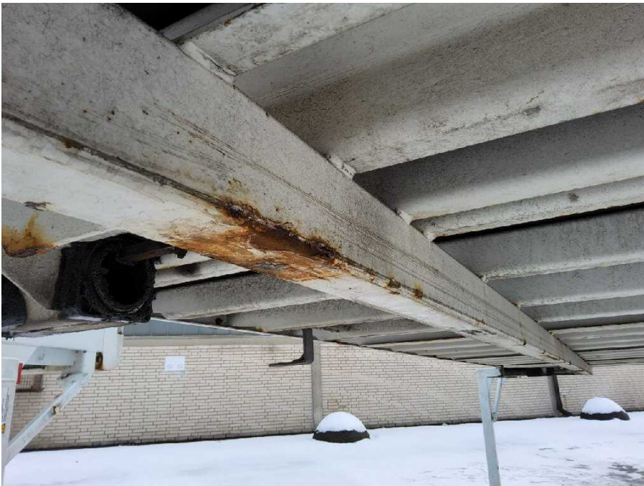
Bild 21 Aufbau Bodenrahmen hinten korrodiert
