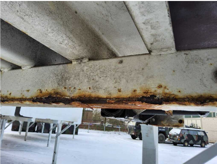
Bild 20 Aufbau Bodenrahmen hinten korrodiert
