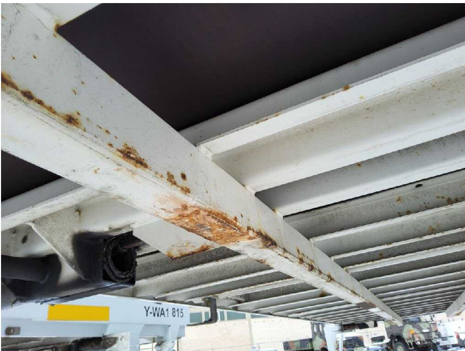
Bild 18 Aufbau Bodenrahmen hinten korrodiert
