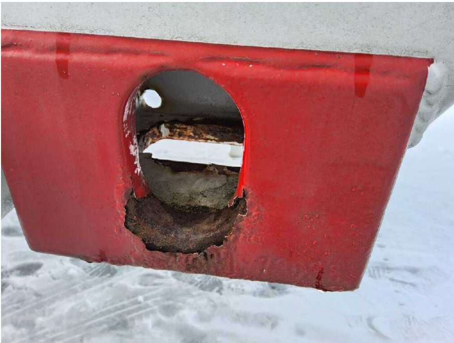
Bild 23 Aufbau Containerverriegelung korrodiert
