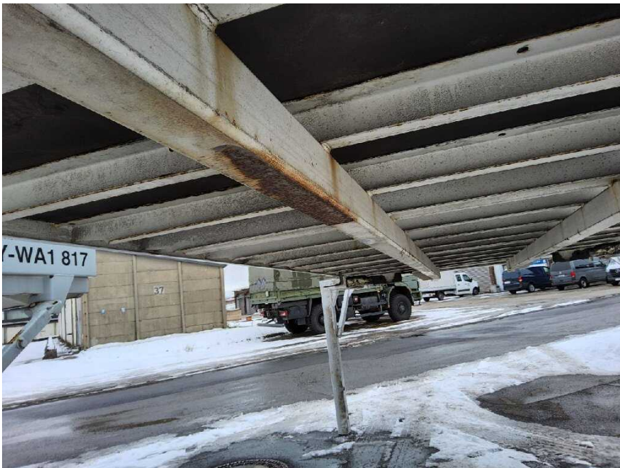
Bild 15 Aufbau Bodenrahmen hinten korrodiert
