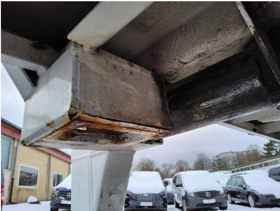
Bild 12 Aufbau Containerverriegelung korrodiert
