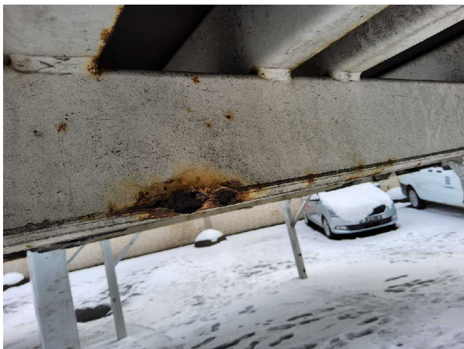
Bild 23 Aufbau Bodenrahmen hinten korrodiert
