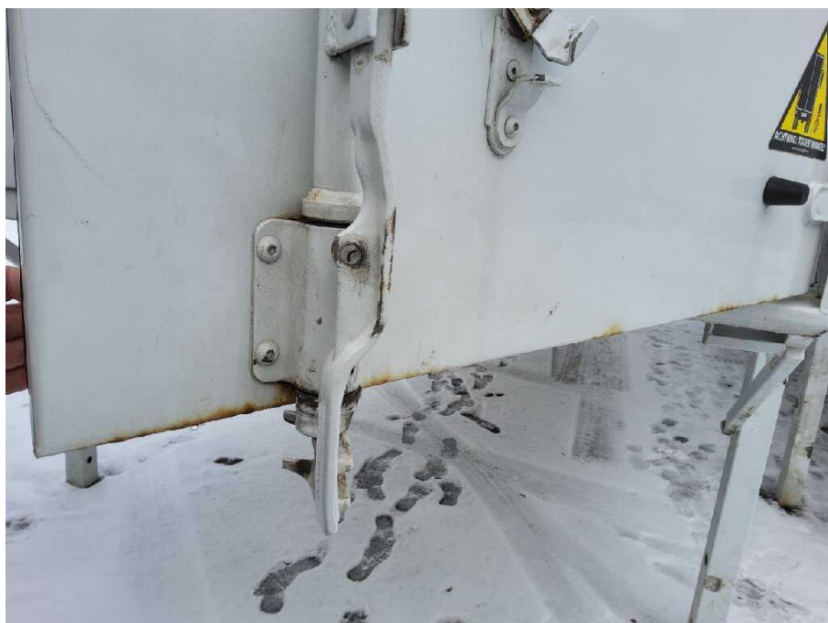
Bild 31 Fahrzeugheck Tür hinten rechts korrodiert
