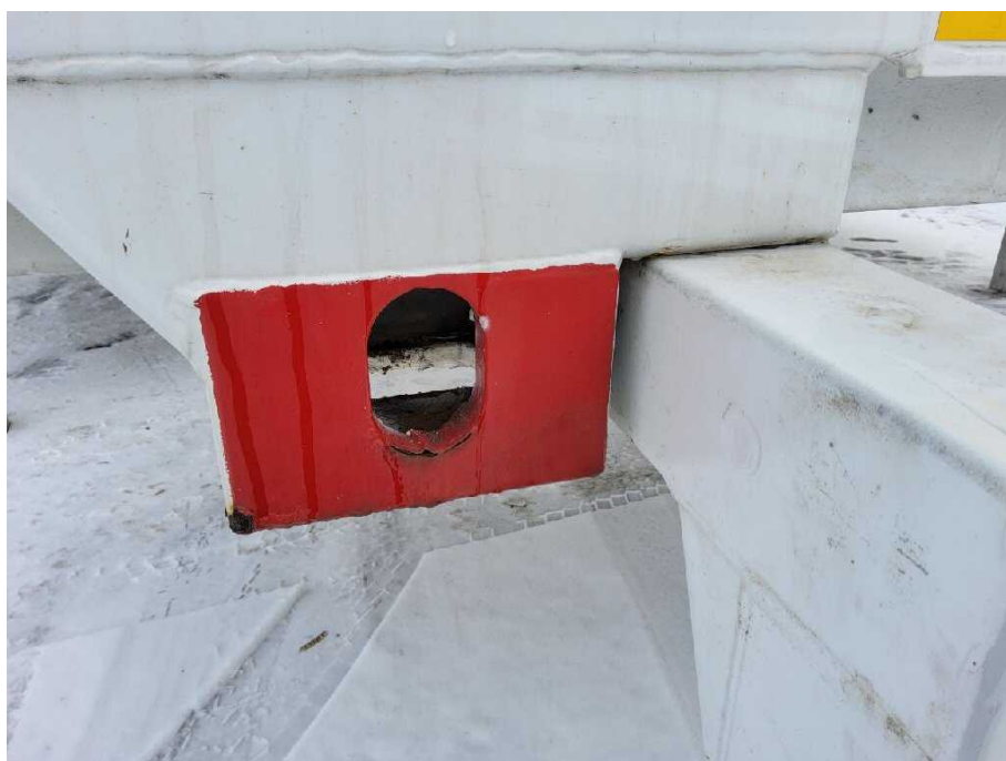
Bild 12 Aufbau Containerverriegelung korrodiert
