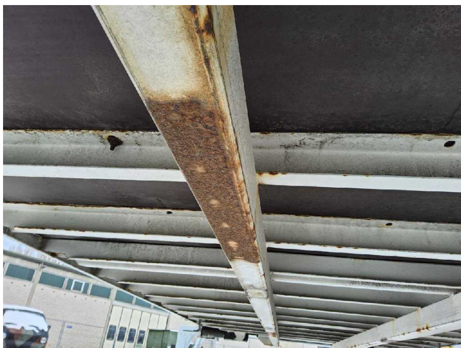
Bild 18 Aufbau Bodenrahmen hinten korrodiert
