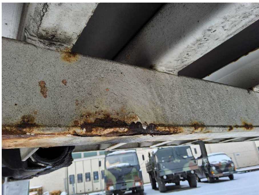
Bild 17 Aufbau Bodenrahmen hinten korrodiert
