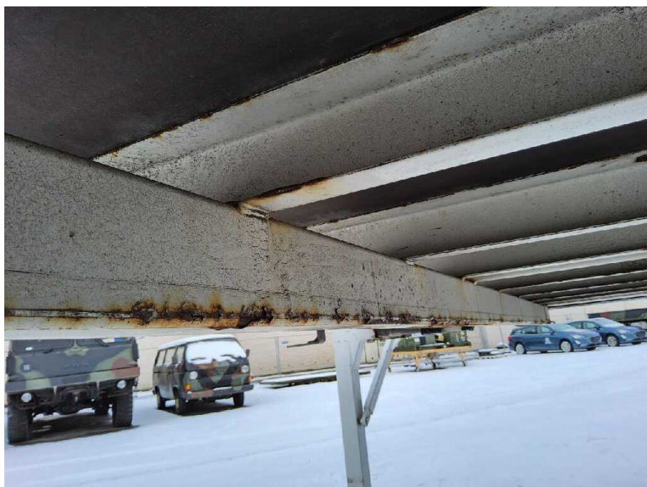
Bild 19 Aufbau Bodenrahmen hinten korrodiert
