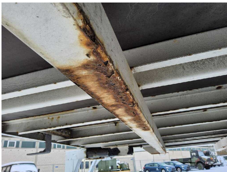
Bild 20 Aufbau Bodenrahmen hinten korrodiert
