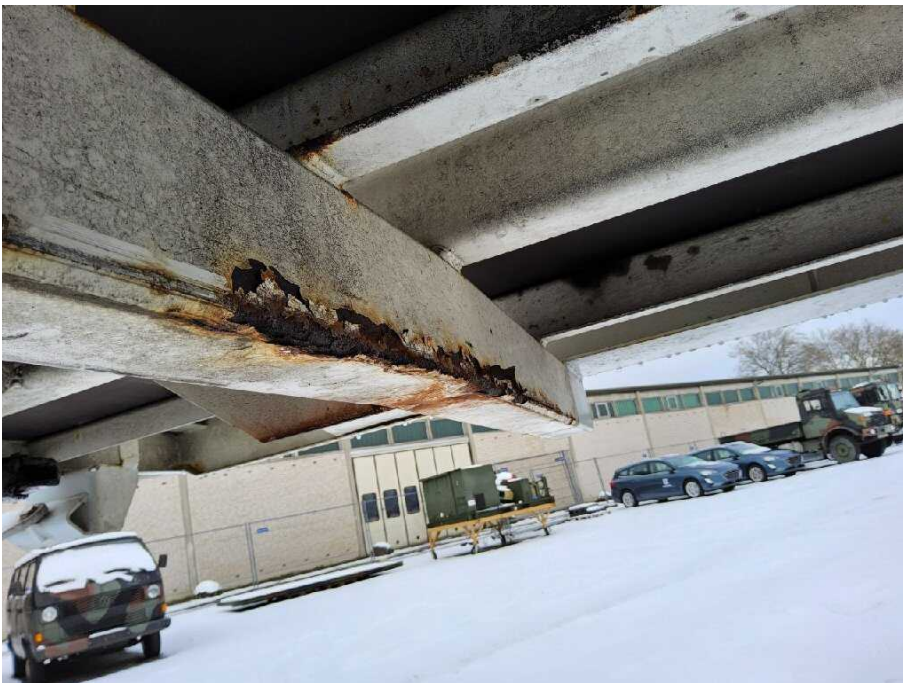
Bild 21 Aufbau Bodenrahmen hinten korrodiert
