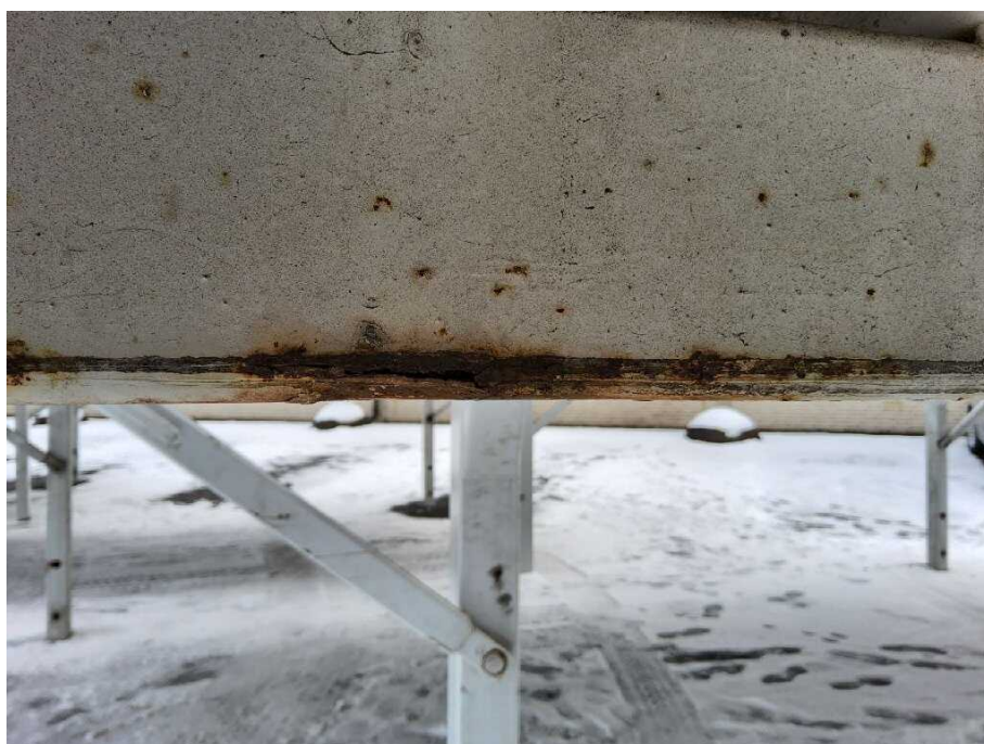
Bild 24 Aufbau Bodenrahmen hinten korrodiert
