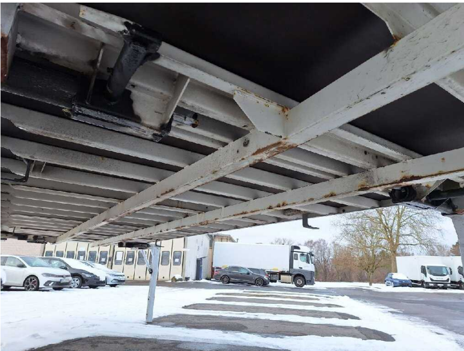
Bild 19 Aufbau Bodenrahmen hinten korrodiert
