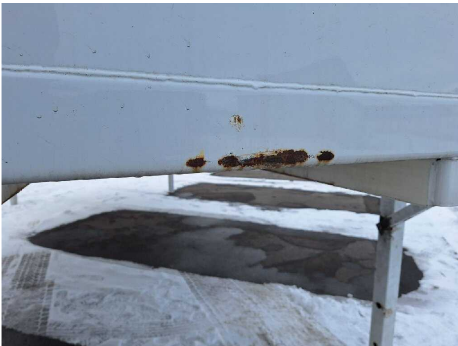
Bild 22 Fahrzeugfront Fahrzeugrahmen korrodiert
