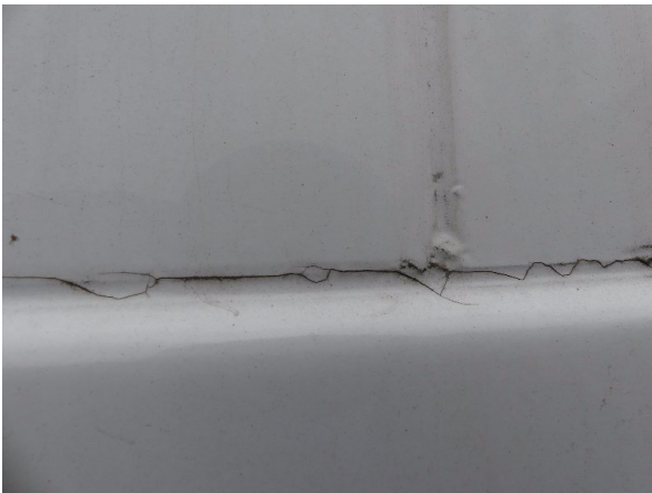
Bild 15: Abdichtung Seitenwand beschädigt - erneuern
