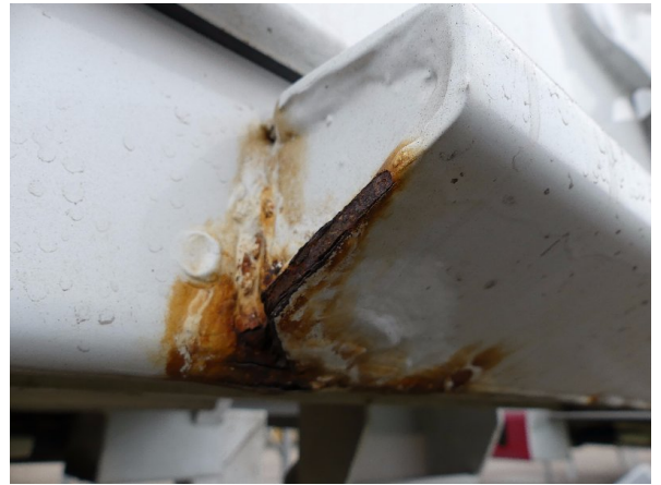
Bild 20: Eckbeplankung rechts Korrosion - instandsetzen und lackieren
