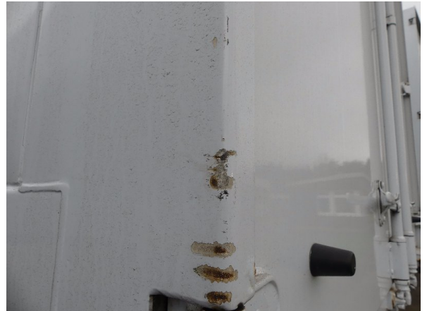
Bild 22: Eckbeplankung links Korrosion - instandsetzen und lackieren
