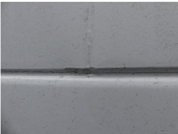
Bild 17: Abdichtung Seitenwand beschädigt - erneuern
