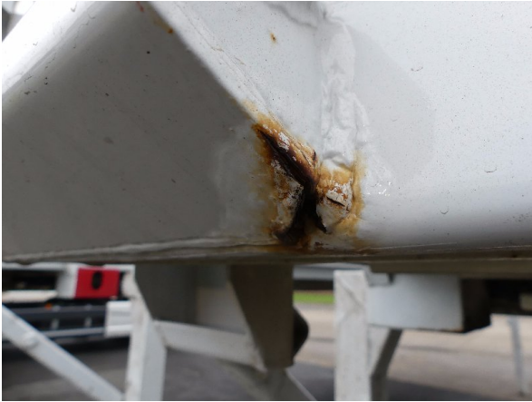
Bild 23: Eckbeplankung links Korrosion - instandsetzen und lackieren
