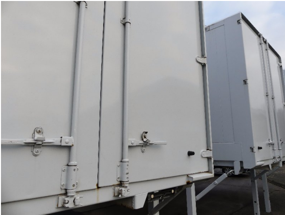
Bild 25: Tür rechts Korrosion - instandsetzen und lackieren
