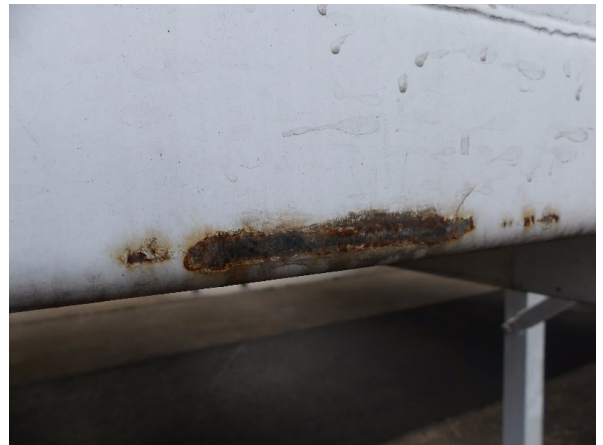
Bild 16: Frontwand Korrosion - instandsetzen und lackieren
