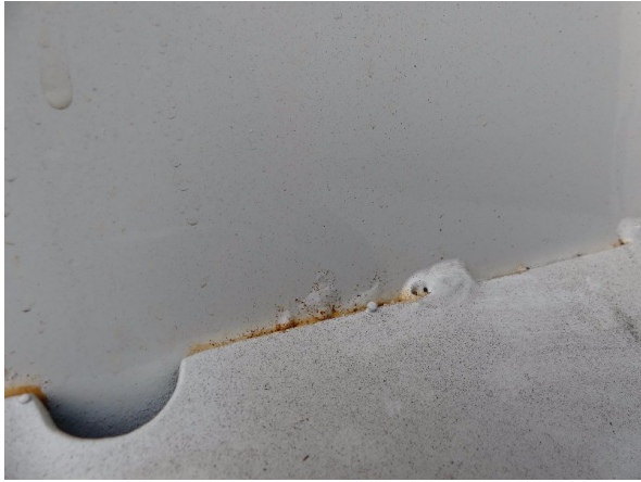
Bild 13: Tür links Korrosion - instandsetzen und lackieren
