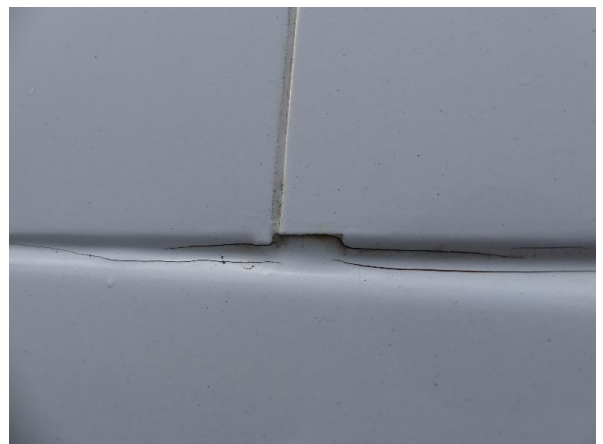
Bild 18: Abdichtung Seitenwand links und rechts beschädigt - erneuern
