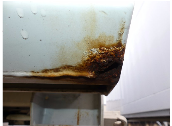
Bild 22: Eckbeplankung rechts Korrosion - instandsetzen und lackieren
