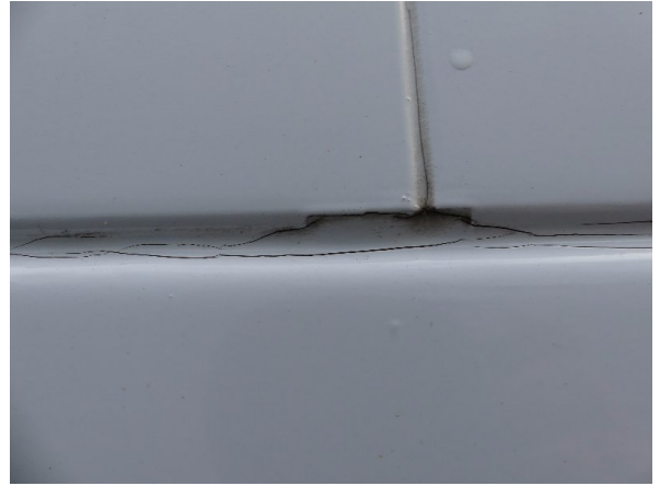
Bild 20: Abdichtung Seitenwand links und rechts beschädigt - erneuern
