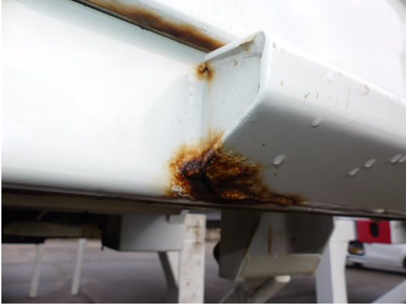
Bild 23: Eckbeplankung rechts Korrosion - instandsetzen und lackieren
