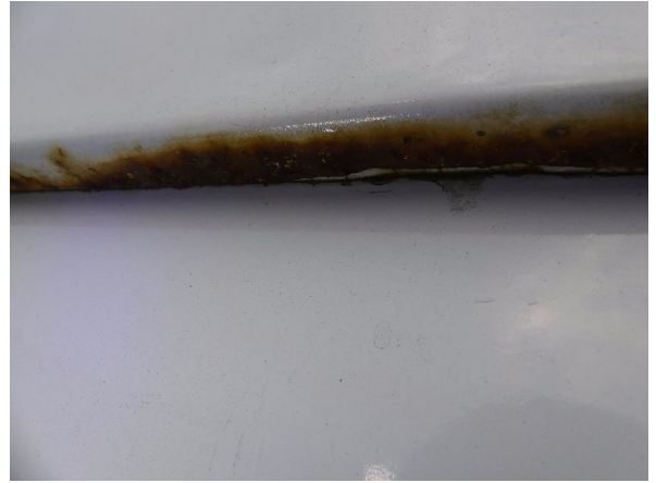
Bild 14: Tür links Korrosion - instandsetzen und lackieren
