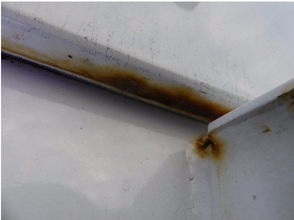
Bild 27: Tür rechts Korrosion - instandsetzen und lackieren
