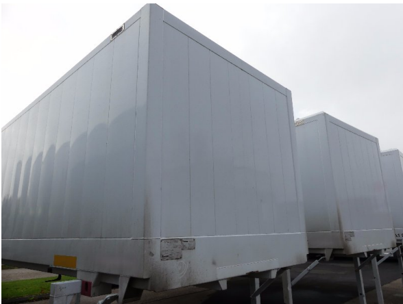
Bild 12: Frontwand Korrosion - instandsetzen und lackieren
