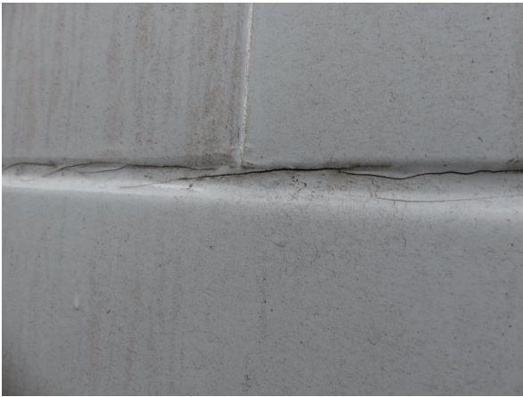
Bild 15: Abdichtung links und rechts beschädigt - erneuern
