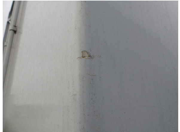
Bild 20: Eckbeplankung rechts Korrosion - instandsetzen und lackieren
