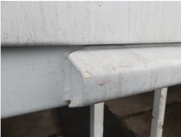
Bild 21: Eckbeplankung rechts Korrosion - instandsetzen und lackieren
