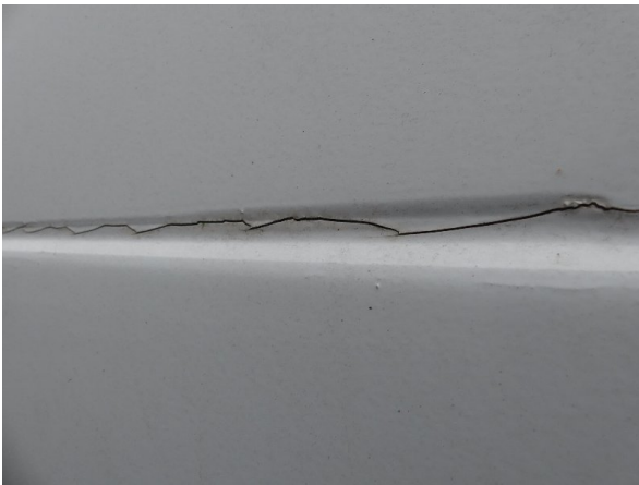
Bild 17: Abdichtung links und rechts beschädigt - erneuern
