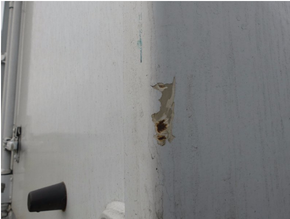
Bild 19: Eckbeplankung rechts Korrosion - instandsetzen und lackieren
