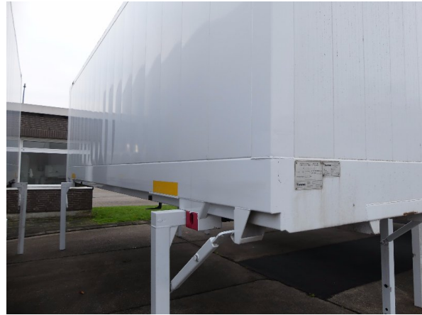
Bild 14: Abdichtung Seitenwand links und rechts beschädigt - erneuern
