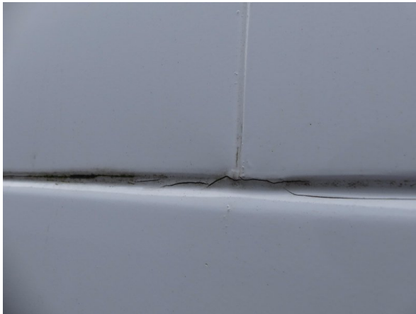
Bild 15: Abdichtung Seitenwand links und rechts beschädigt - erneuern
