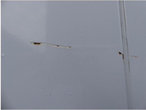
Bild 19: Eckbeplankung rechts Korrosion - instandsetzen und lackieren
