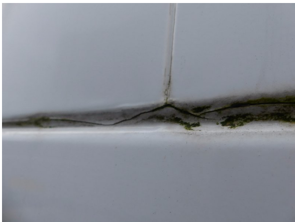
Bild 17: Abdichtung Seitenwand links und rechts beschädigt - erneuern
