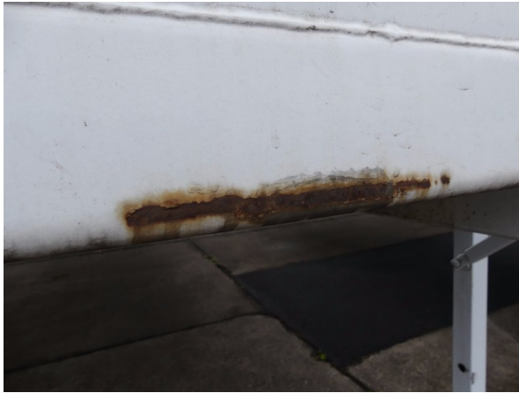
Bild 13: Frontwand Korrosion - instandsetzen und lackieren
