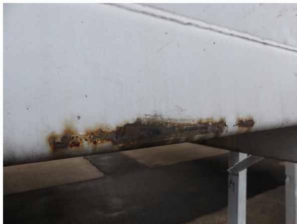
Bild 13: Frontwand Korrosion - instandsetzen und lackieren
