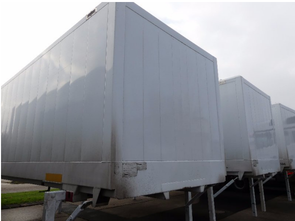
Bild 12: Frontwand Korrosion - instandsetzen und lackieren
