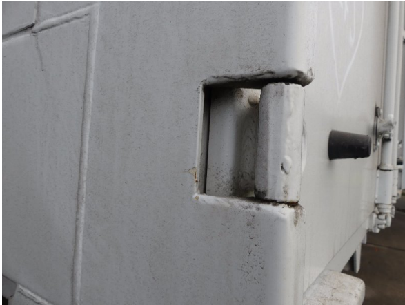
Bild 19: Eckbeplankung unterhalb links Korrosion - instandsetzen und lackieren
