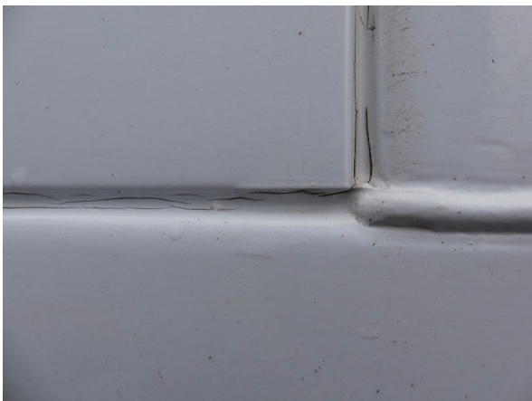
Bild 17: Abdichtung links und rechts beschädigt - erneuern
