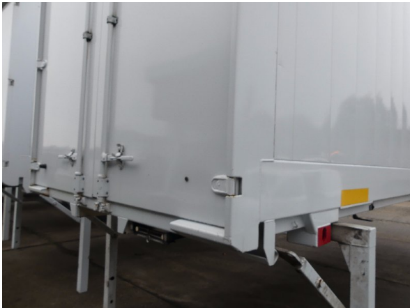
Bild 25: Anschlaggummi fehlt - erneuern
