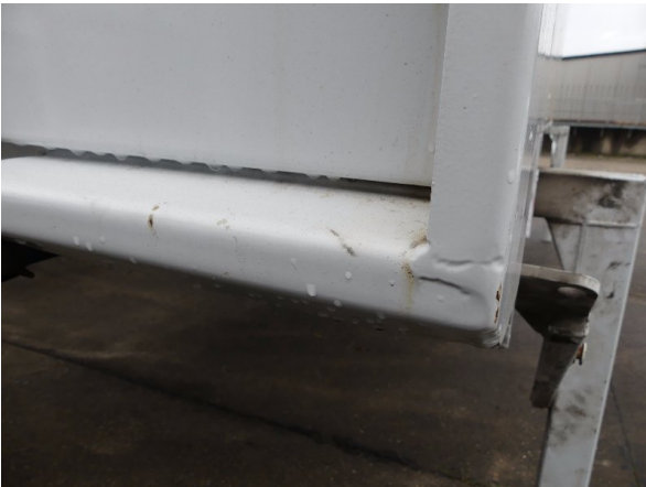
Bild 21: Eckbeplankung rechts Korrosion - instandsetzen und lackieren
