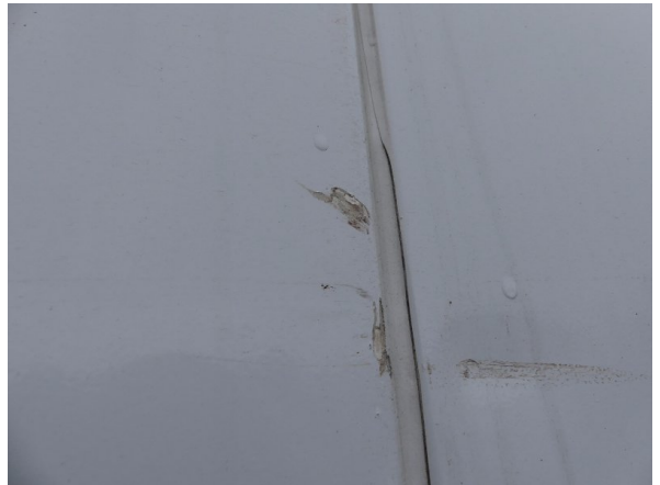
Bild 22: Eckbeplankung rechts Korrosion - instandsetzen und lackieren
