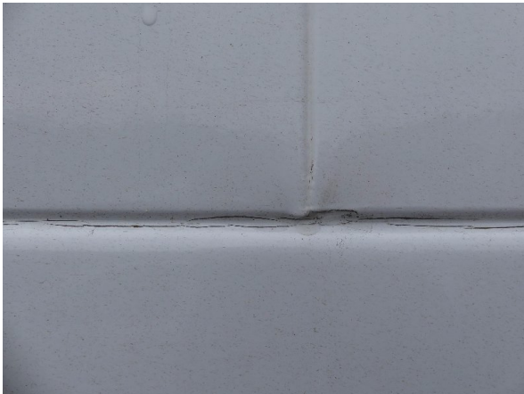
Bild 15: Abdichtung links und rechts beschädigt - erneuern
