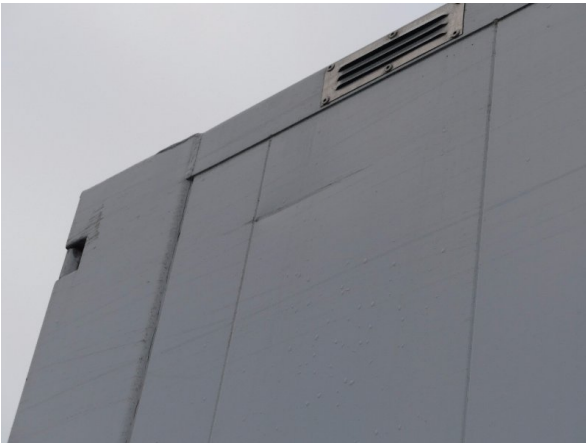
Bild 19: Seitenwand hinten DelleKratzer - instandsetzen und lackieren
