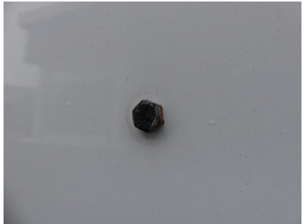
Bild 26: Anschlaggummi fehlt - erneuern
