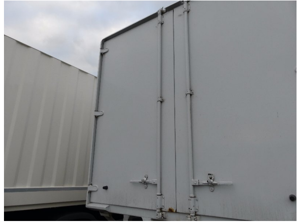
Bild 24: Hecktür links Korrosion - instandsetzen und lackieren
