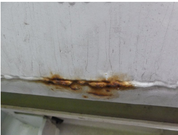
Bild 27: Eckbeplankung unterhalb links Korrosion - instandsetzen und lackieren
