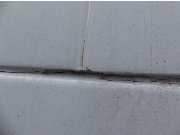
Bild 16: Abdichtung links und rechts beschädigt - erneuern
