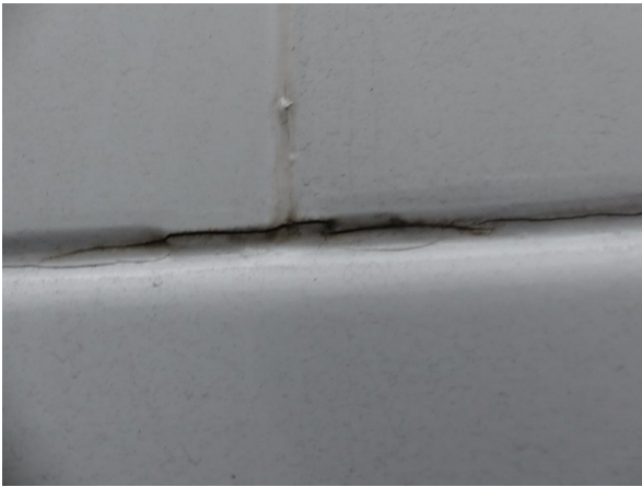
Bild 19: Abdichtung links und rechts beschädigt - erneuern
