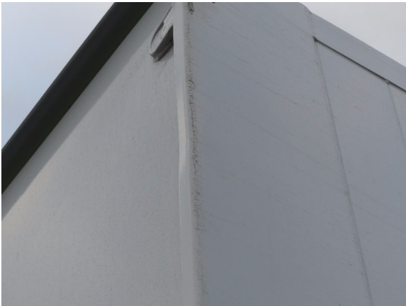
Bild 21: Eckbeplankung rechts Abschürfungen / Korrosion - instandsetzen und lackieren
