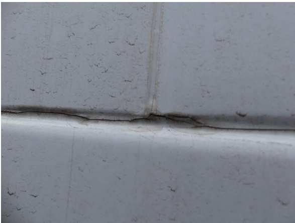
Bild 15: Abdichtung links und rechts beschädigt - erneuern
