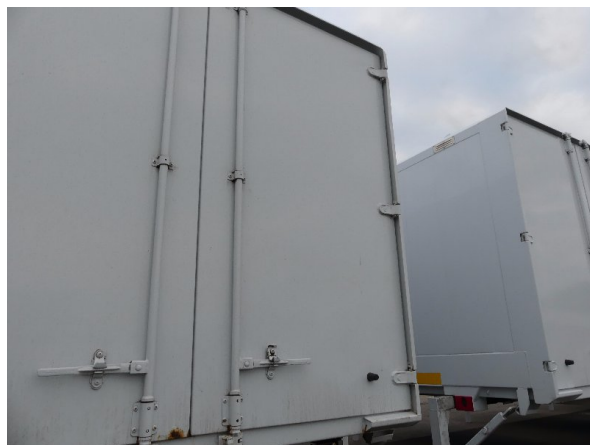
Bild 30: Karosserie / Innenraum Delle / Kratzer / Steinschlag / Abschürfung-ohne Reparatur
