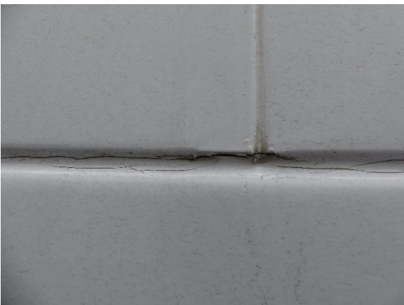
Bild 18: Abdichtung links und rechts beschädigt - erneuern
