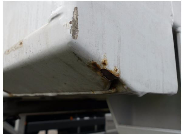
Bild 22: Eckbeplankung rechts Abschürfungen / Korrosion - instandsetzen und lackieren
