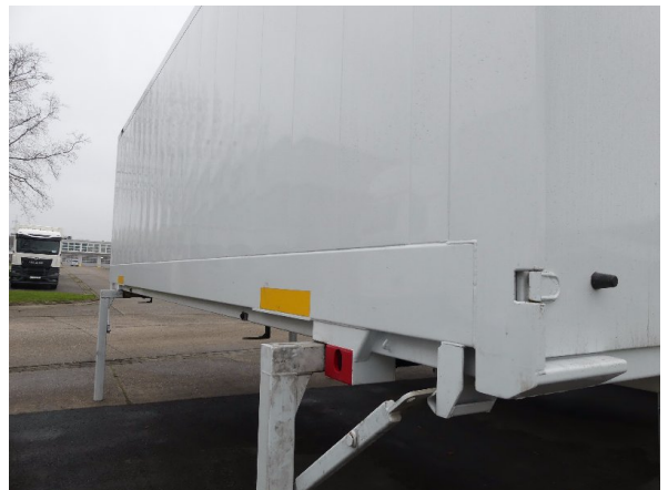
Bild 16: Abdichtung links und rechts beschädigt - erneuern
