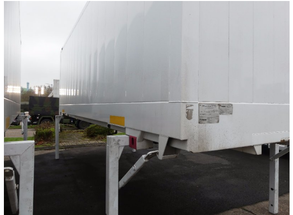
Bild 14: Abdichtung links und rechts beschädigt - erneuern
