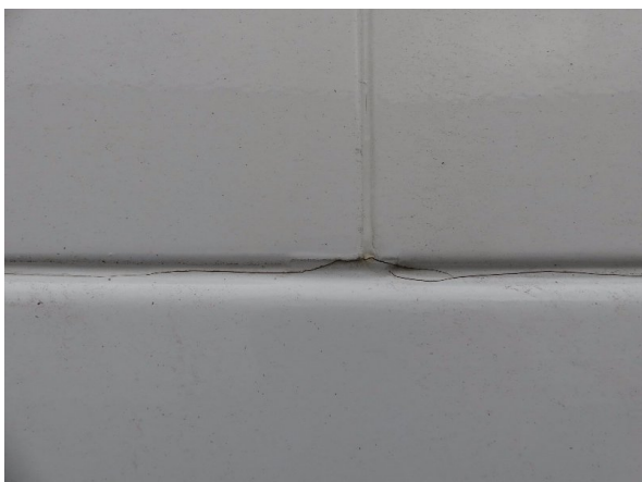
Bild 17: Abdichtung links und rechts beschädigt - erneuern
