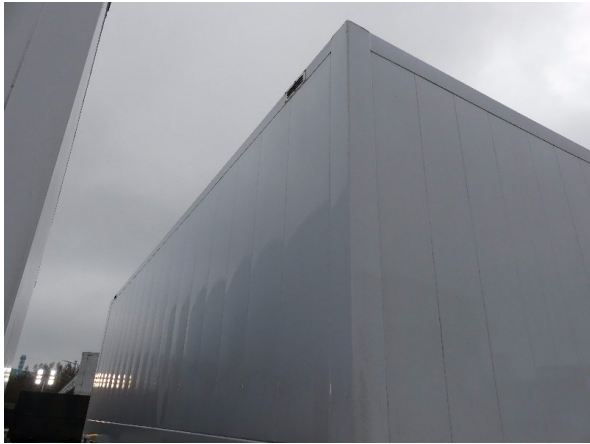
Bild 23: Karosserie Delle / Kratzer / Abschürfung - ohne Reparatur
