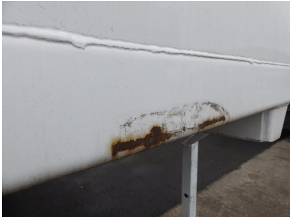
Bild 13: Frontwand Korrosion - instandsetzen und lackieren
