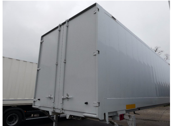
Bild 20: Eckbeplankung rechts Korrosion - instandsetzen und lackieren
