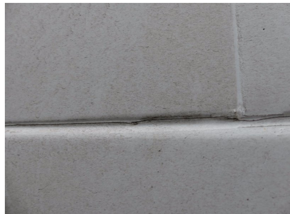
Bild 18: Abdichtung links und rechts beschädigt - erneuern
