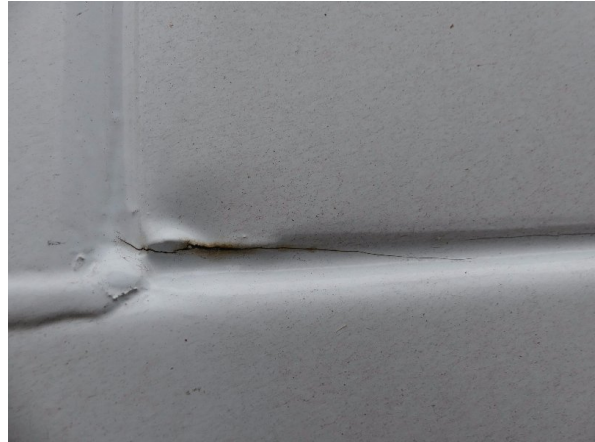
Bild 20: Abdichtung links und rechts beschädigt - erneuern
