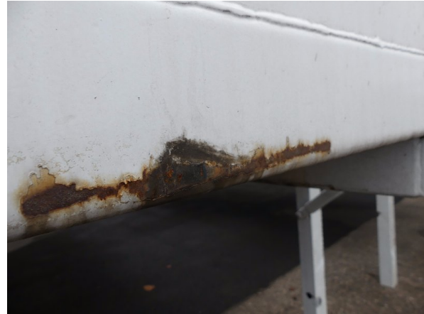
Bild 16: Frontwand Korrosion - instandsetzen und lackieren
