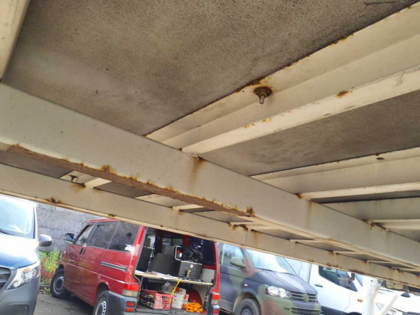
Beschädigung 1: Aufbau: Aufbau - Korrosion - instandsetzen und lackieren
