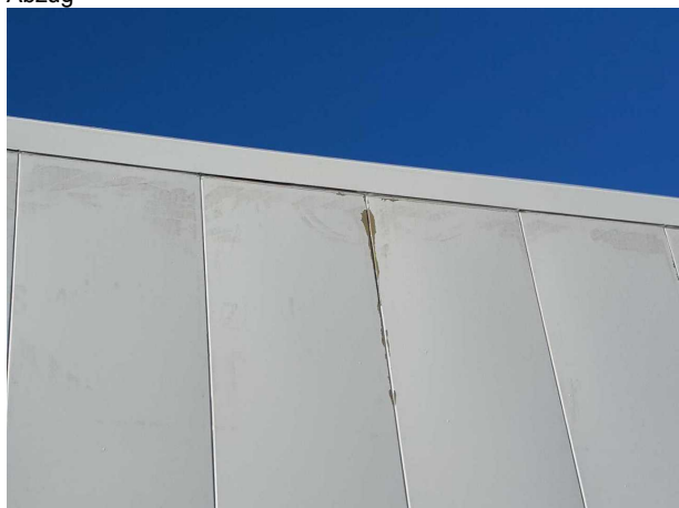
Gebrauchsspur 1: Karosserie: Karosserie - beschädigt - kein Abzug
