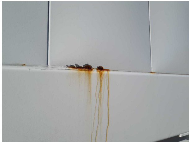
Gebrauchsspur 1: Karosserie: Karosserie - beschädigt - kein Abzug
